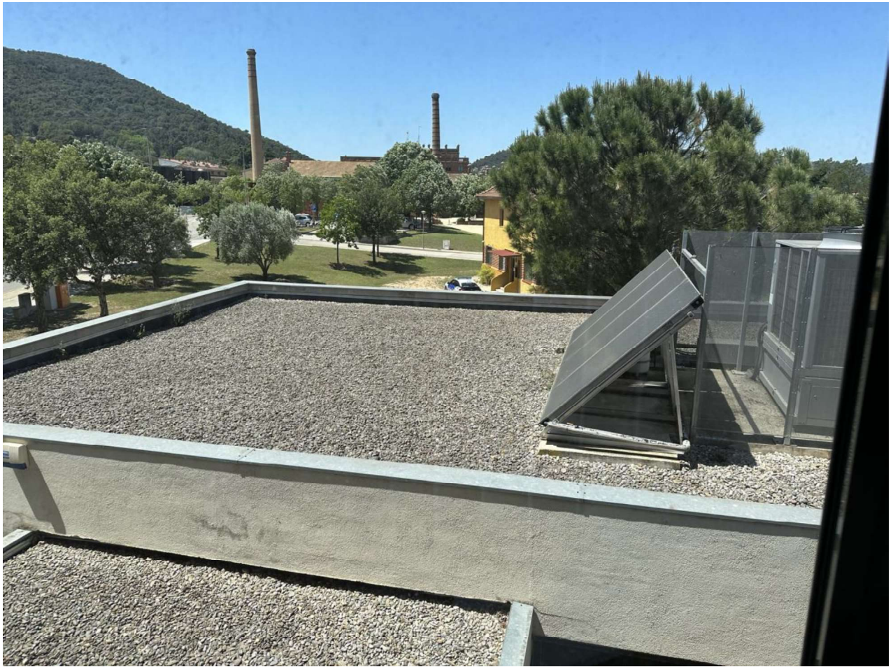
Coberta plana, en la qual se situa un apart del camp fotovoltaic
