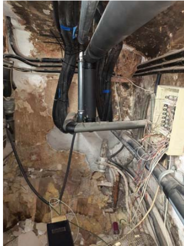
Detall punt entrada canonada aigua freda a altell cuina
