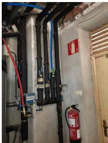
Detall distribució aigua freda en sala calderes
