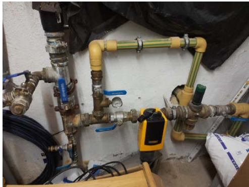
Detall punt entrada aigua freda edifici DISTRIBUCIÓ PART VELLA
