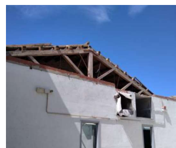
Imatges de patologies de coberta i façana nau E. Font: Topomira i Ajuntament de Calders.
