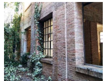
Imatges de patologies de coberta i façana nau C. Font: Topomira i Ajuntament de Calders.
