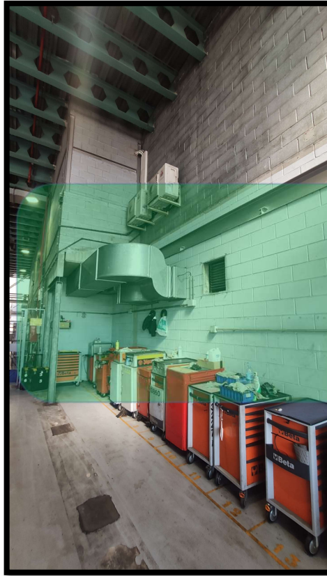
Imatge 3 – situació equips recuperadors
