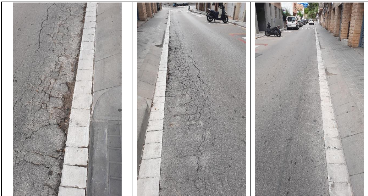
Imatges de diverses patologies
