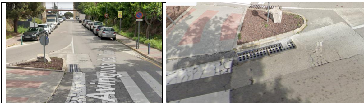
Imatges del paviment esgotat a la zona de l'embornal
