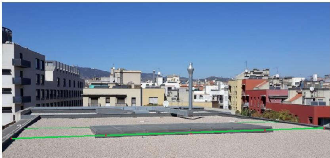
Imatge 10. Anclatge de línia de vida a l'ampit de la coberta
