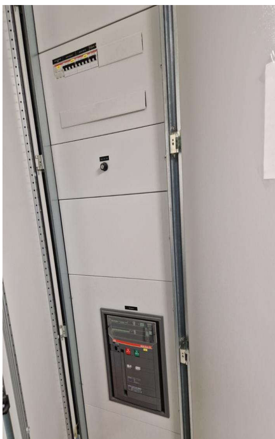
Foto 9. Detall quadre electric
