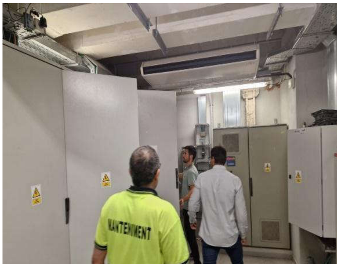
Foto 8. Zona Instal·lacions elèctriques edifici
