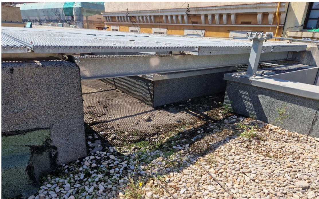
Foto 4 Coberta, zona de pas cables
