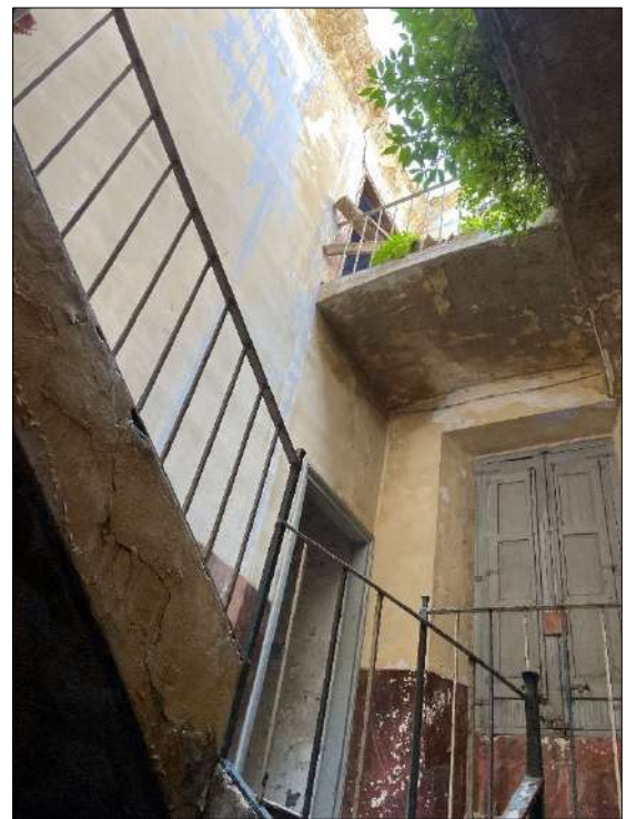
Sostre caigut de l'escala secundària.
