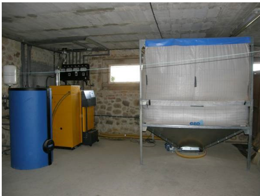
Figura 1. Local tècnic d'una instal·lació domèstica de caldera de biomassa amb sitja tèxtil.
