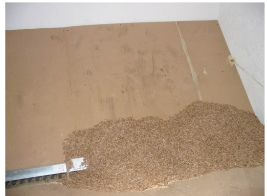
Figura 5. Interior d'una sitja d'obra on s'aprecien les rampes a 45° d'inclinació i el vis sens fi que extreu el pèl·let i que el condueix a l'alimentació de la caldera.
