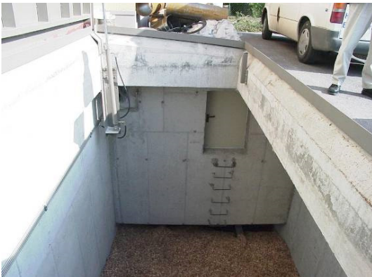
Figura 4. Interior d'una sitja de gran capacitat, amb entrada de biocombustible a cota "0" i on es pot apreciar el registre d'accés a la sitja.
