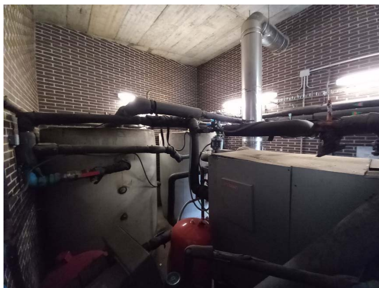
Imatge 1: Calderes i dipòsits de Inèrcia
