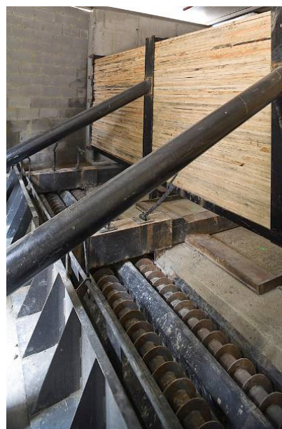
Figura 15. A l'altra banda de la sitja es troben els visos sens fi que porten el pèl·let fins a les calderes, a la sala contigua.
