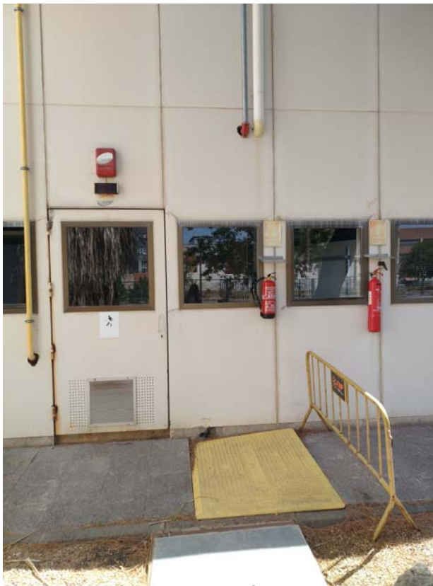
Sala instal·lacions. Extintors, arribada gas i aigua
