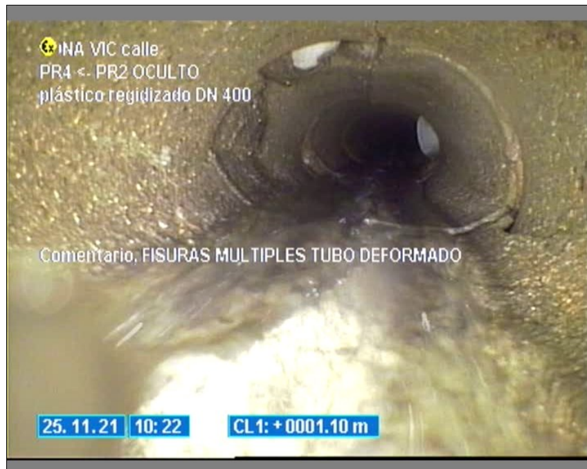
Foto: 3_2A, Medio N°: 251121_1, 00:00:22 1,1m, Comentario / FISURAS MULTIPLES TUBO DEFORMADO
