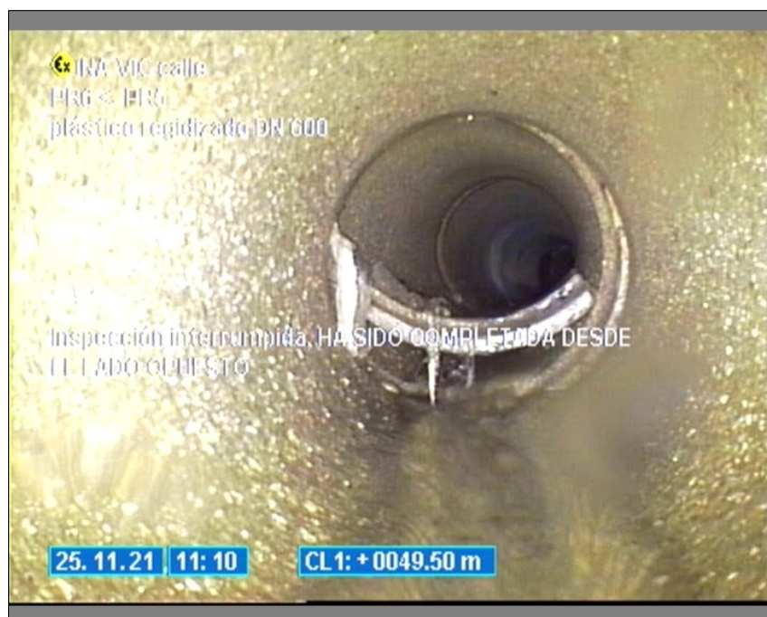
Foto: 6_3A, Medio N°: 251121_1, 00:06:37 49,5m, Inspección interrumpida / HA SIDO COMPLETADA DESDE EL LADO OPUESTO
