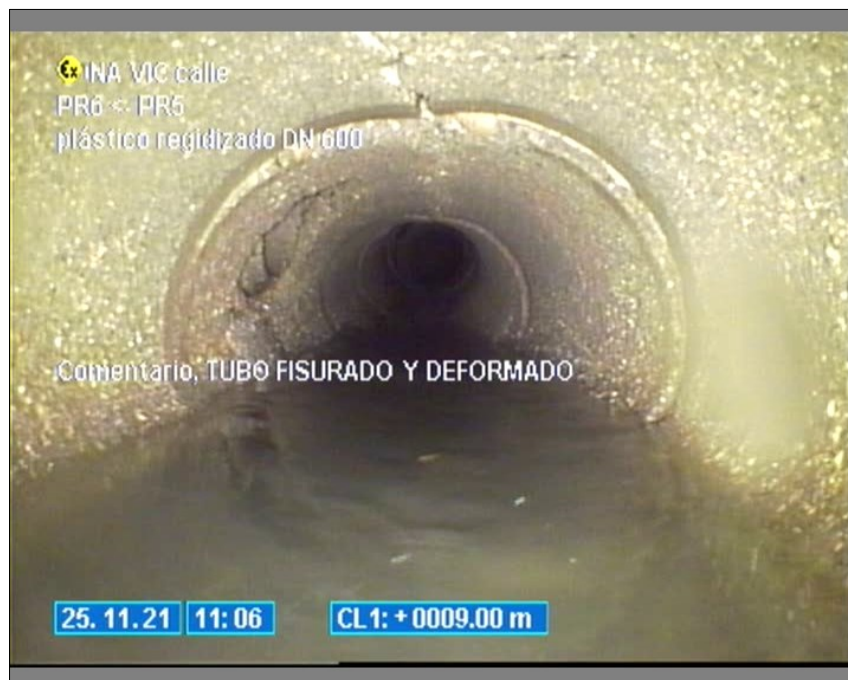
Foto: 6_2A, Medio N°: 251121_1, 00:02:24 9m, Comentario / TUBO FISURADO Y DEFORMADO
