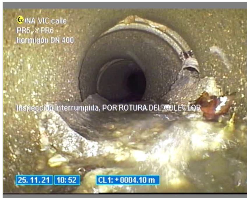
Foto: 5_2A, Medio N°: 251121_1, 00:01:09 4,1m, Inspección interrumpida / POR ROTURA DEL COLECTOR
