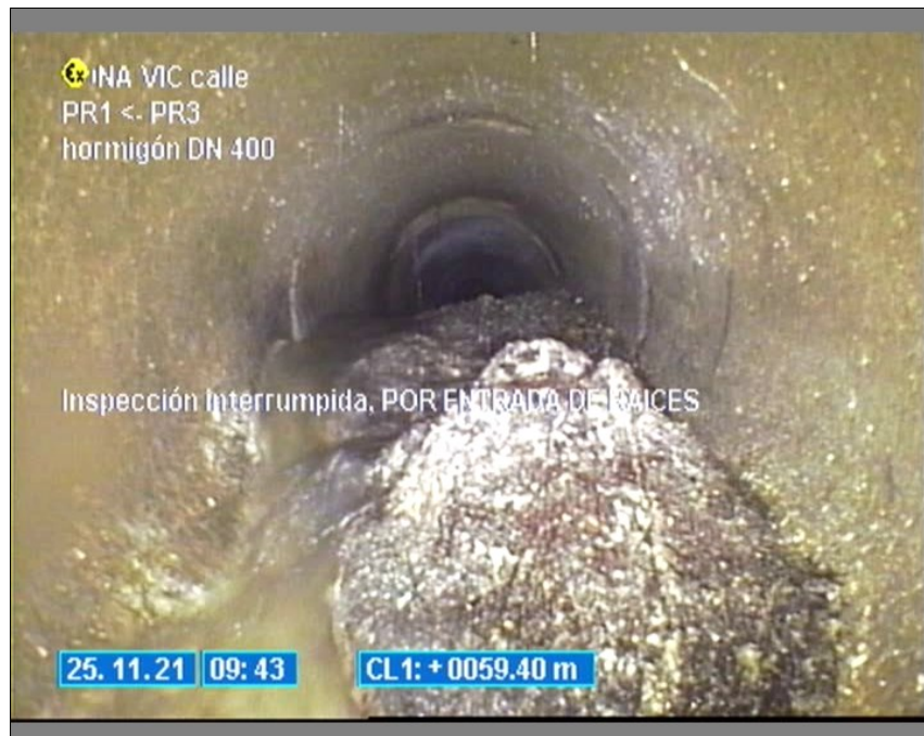
Foto: 2_2A, Medio N°: 251121_1, 00:04:41 59,4m, Inspección interrumpida / POR ENTRADA DE RAICES
