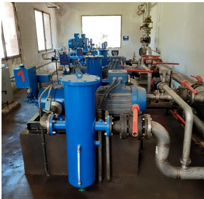
Figura 7. Compresores de recirculación existentes y sus filtros asociados.
