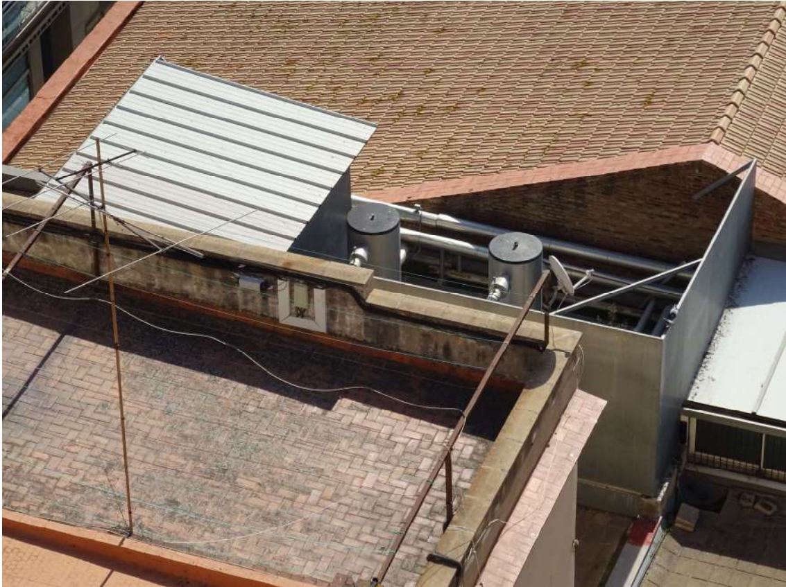
MAQUINÀRIA CLIMATITZACIÓ TERRAT
