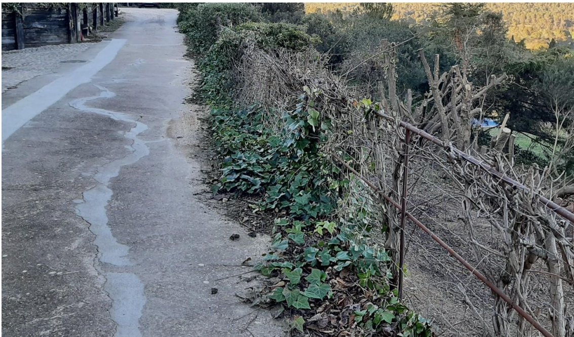
Fotografia 4_Detall de les fissures, prèviament reparades.
