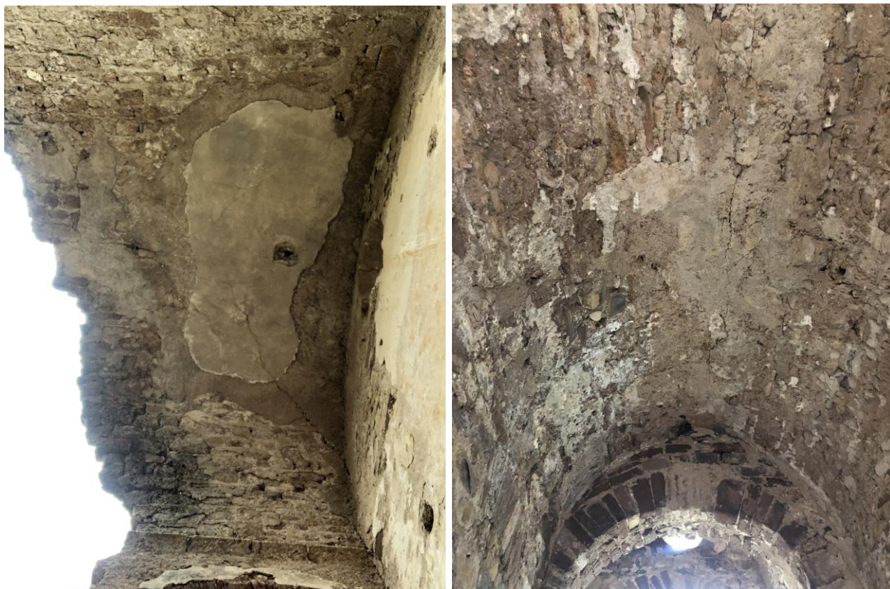
Imatges 17 i 18. Aspecte general de les fissures a l'intradós de les voltes de les naus romànica i preromànica, respectivament.
