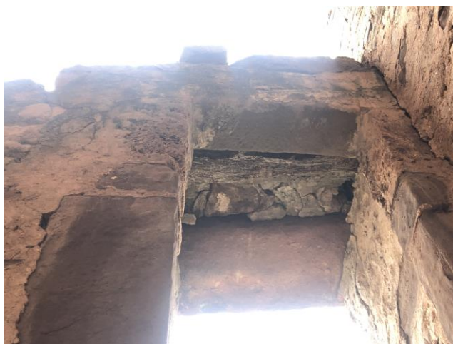
Imatge 33. Vista de la biga de fusta degradada a una llinda.
