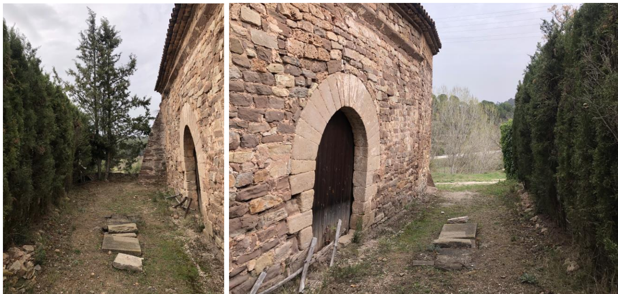
Imatges 31 i 32. Aspecte general del vinclament i desplom del mur de la façana nord-oest.
