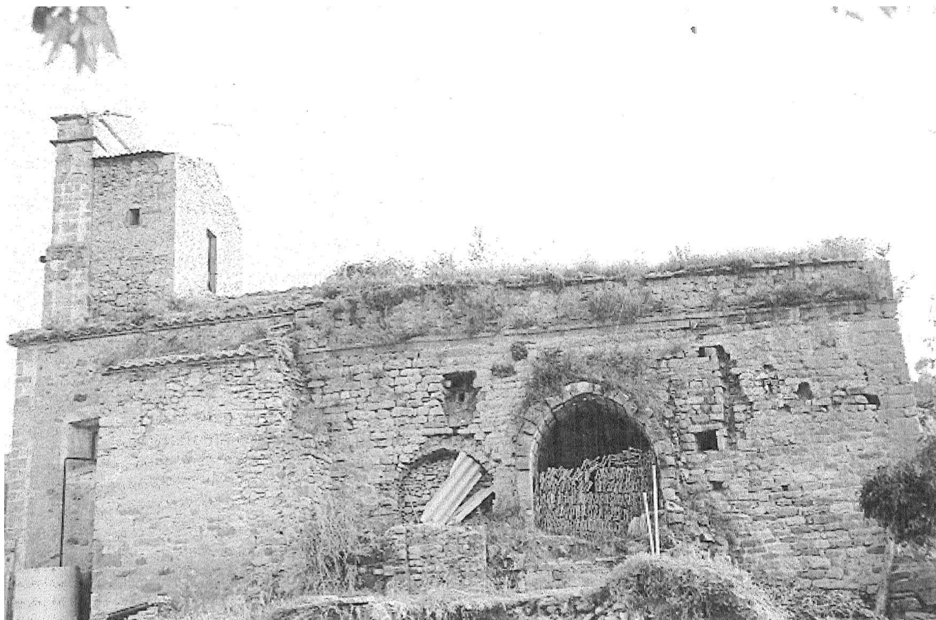
1956 - Façana nord nau romànica actualment esfondrada - Font: SPAL
