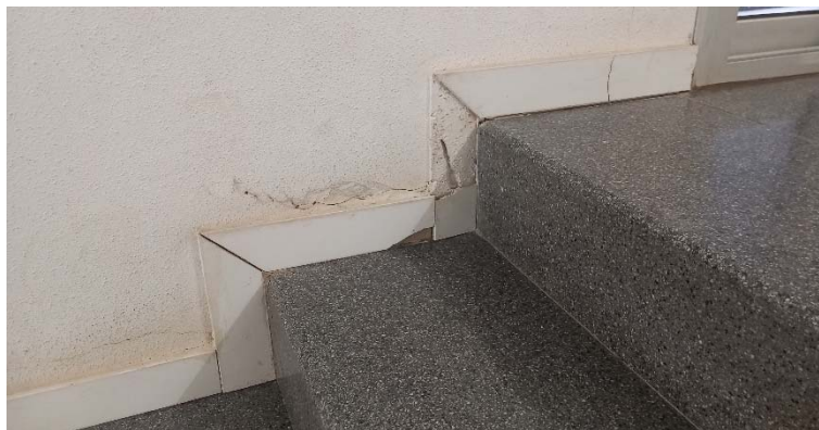
Fotografia 11: Detall Esclaons deteriorats
