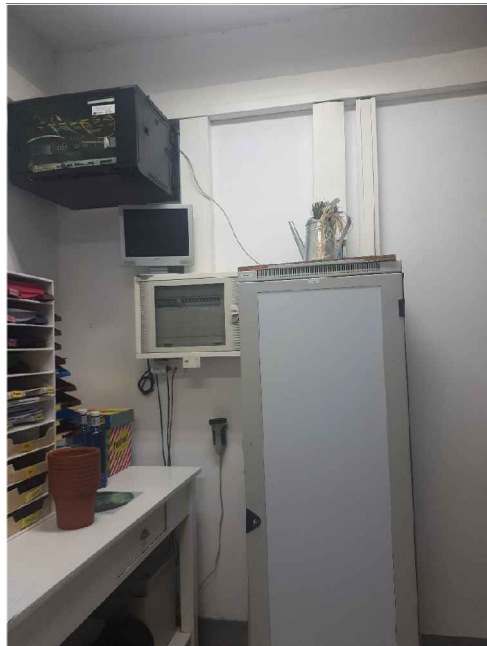
RACK I ELEMENTS ELÈCTRICS
