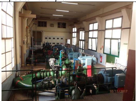
Estació elevadora Abrera)
