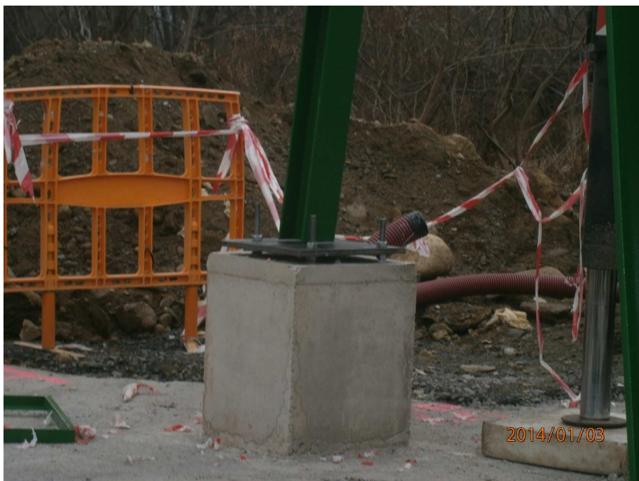
Detall del dau del pilaret de formigó de suport de la sitja instal·lada el gener de 2014
