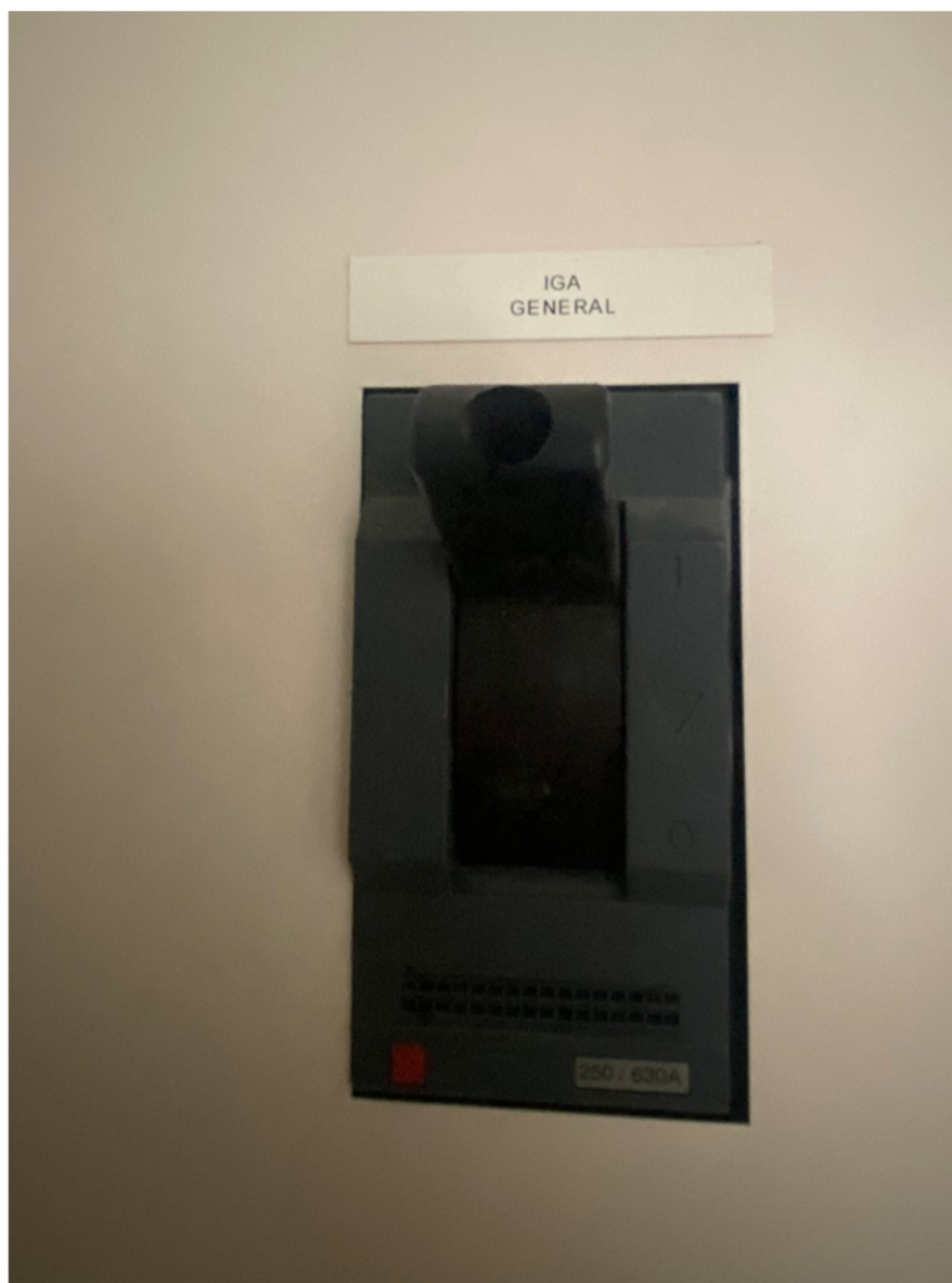
Fig. 4.7. Interruptor General Automàtic (IGA)
