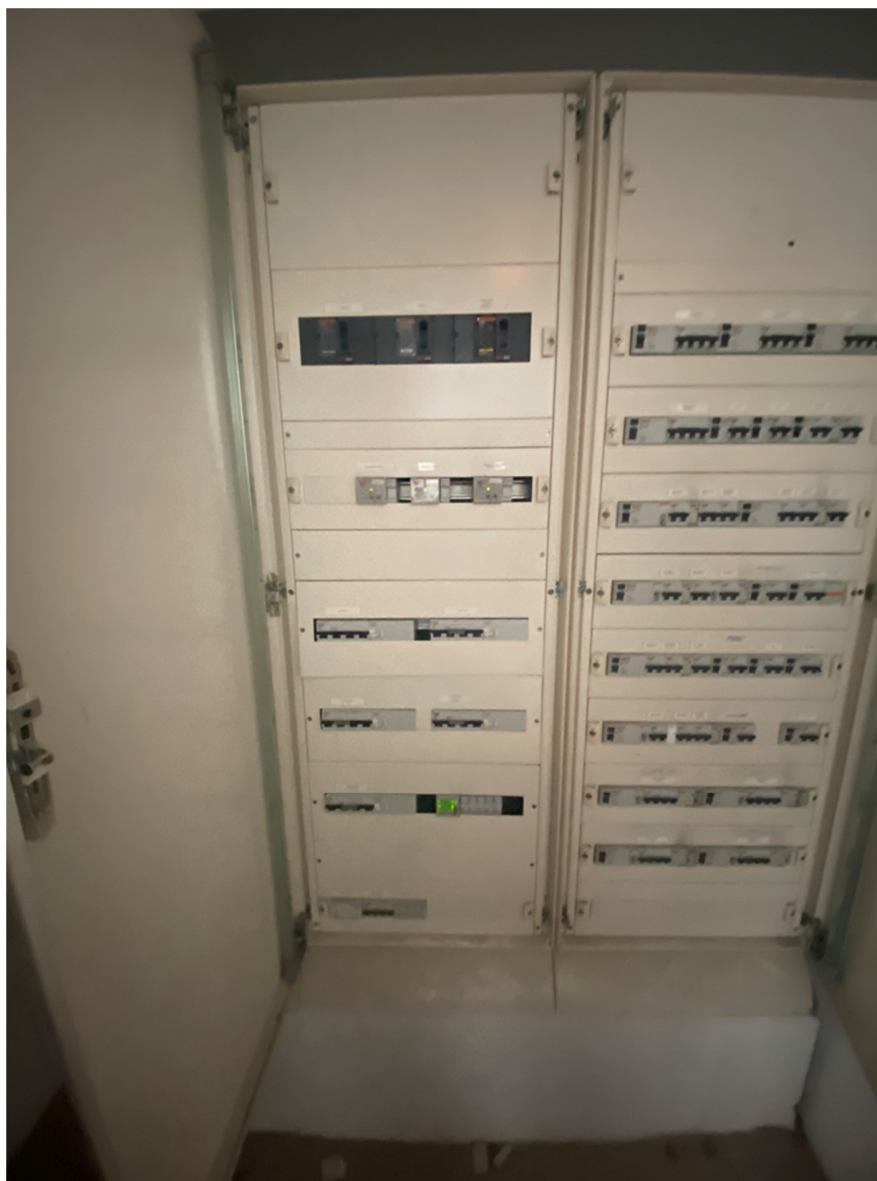
Fig. 4.6. Quadre General de Protecció
