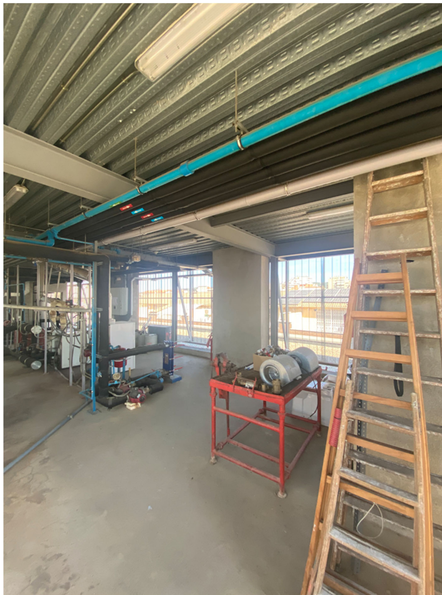
Fig. 4.3. Sala de màquines
