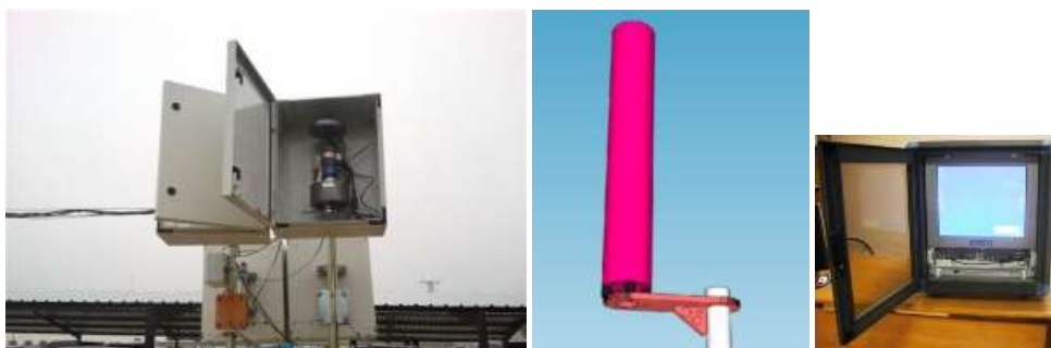
Detalls dels equips de la xarxa AED+H10
