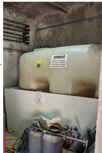
Dipòsit de gasoil a retirar
