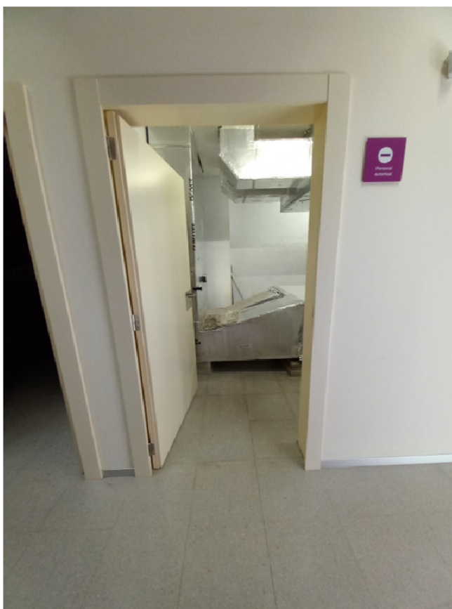
Interior Accés a la sala tècnica
