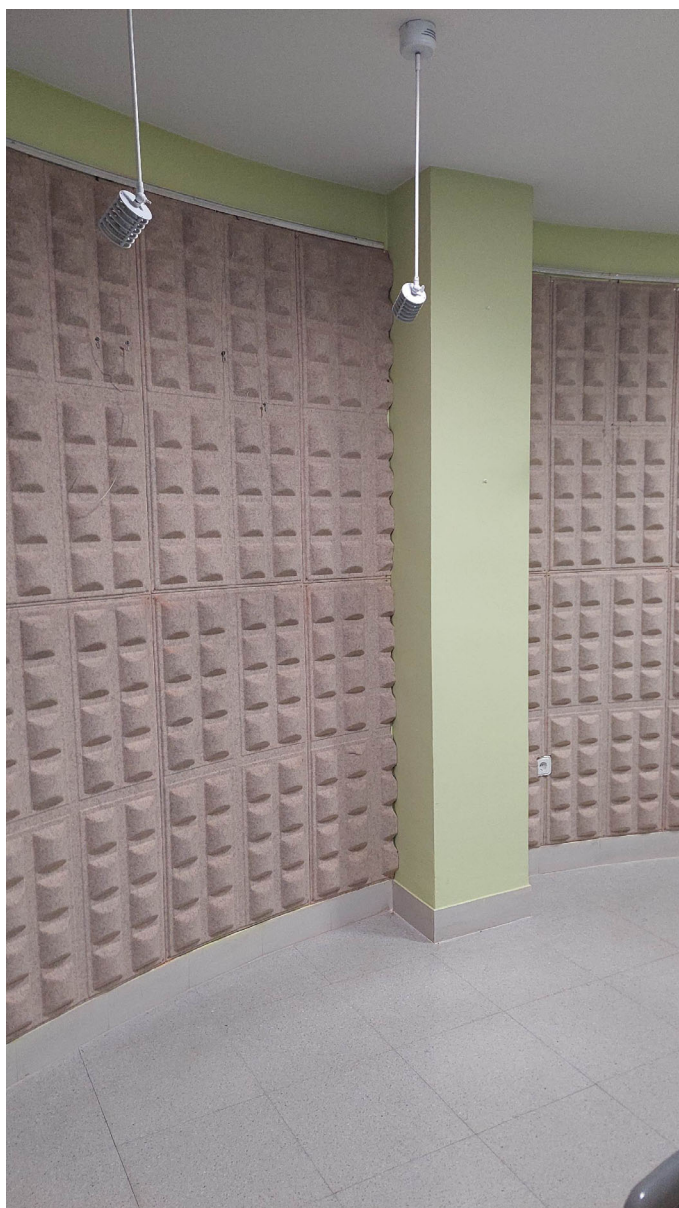
Planta primera, el tub pujarà pel racó d'aquest pilar.
