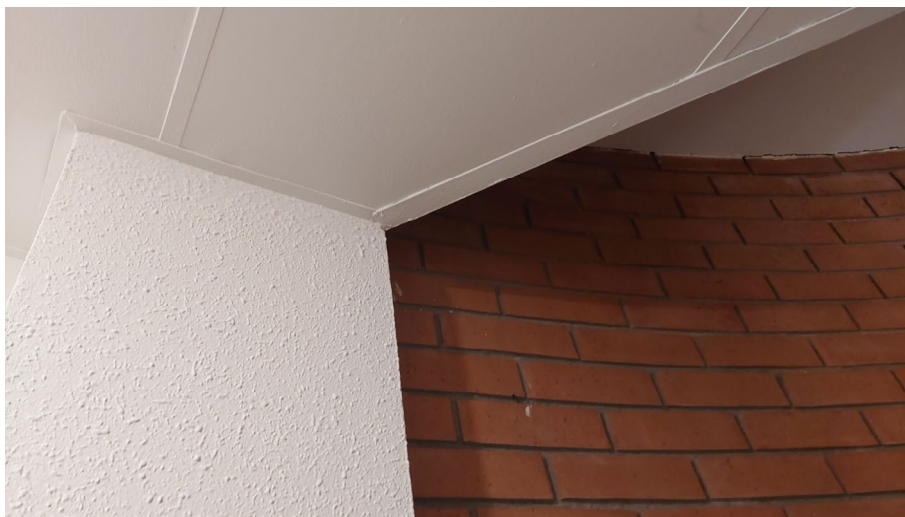
Detall de fals sostre de PB, que caldrà ampliar.
