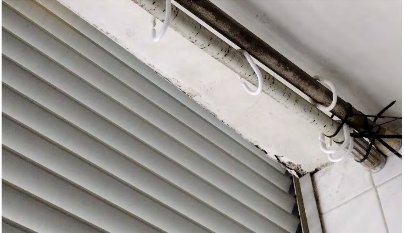
Habitatge 3-1: Inici d'oxidació, cal intervenir
