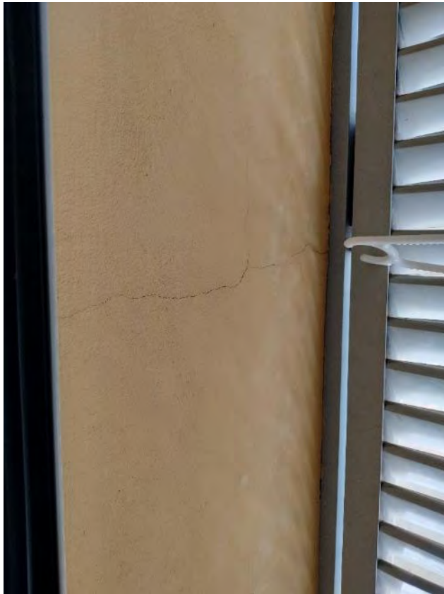
Habitatge 1-1, fissura horitzontal
