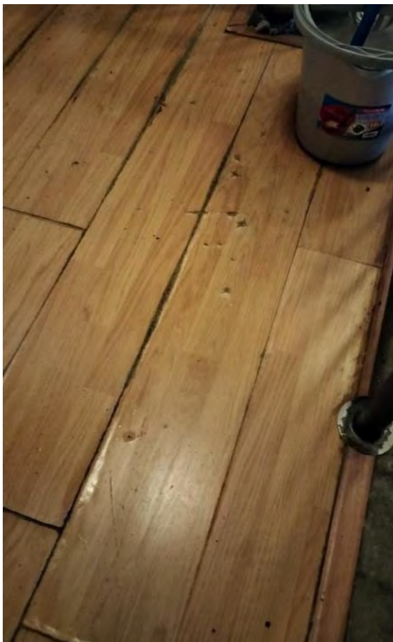
Habitatge 3-3: Parquet, molt deteriorat.
