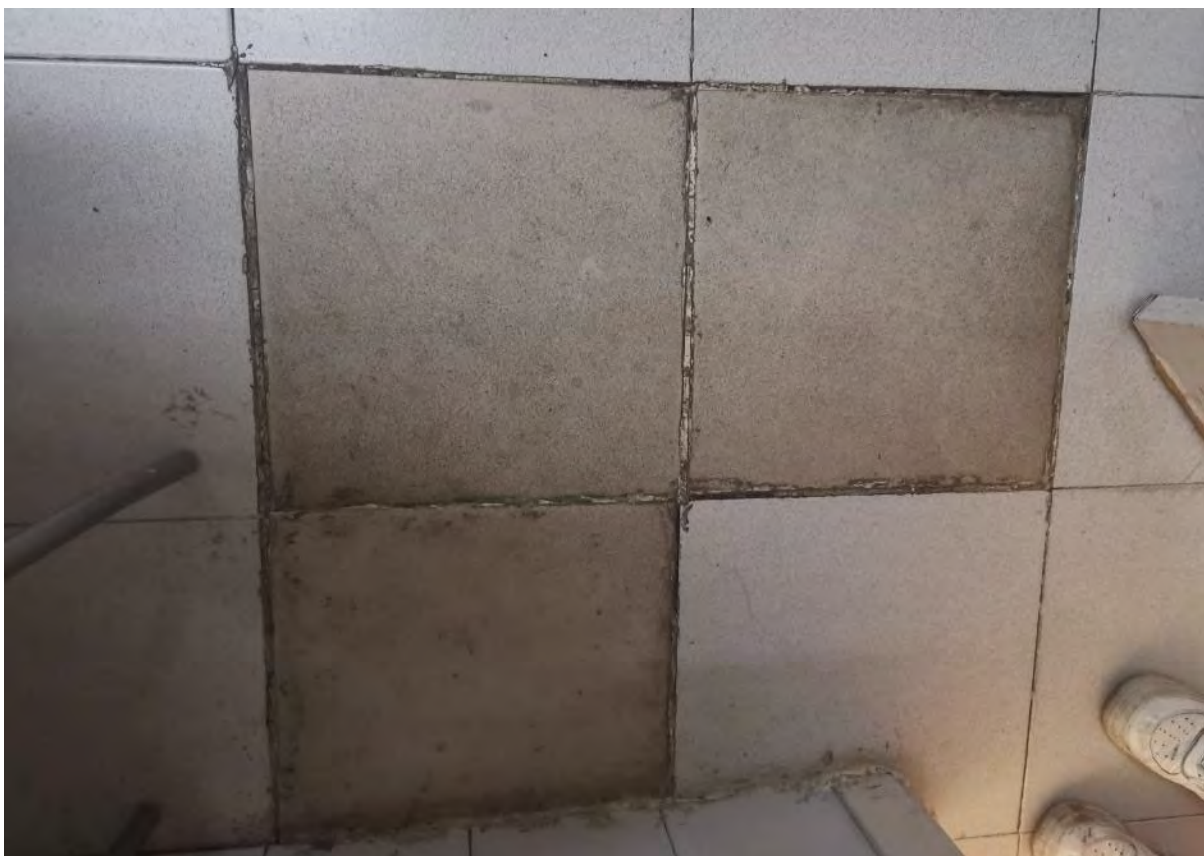
Habitatge 3-4: Paviment ceràmic en cuina i banys amb peces trencades i/o sueltas.
