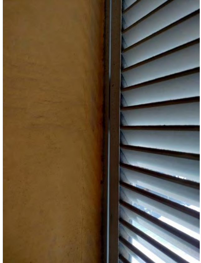
Habitatge 1-2 fissura vertical, mol lleugera
