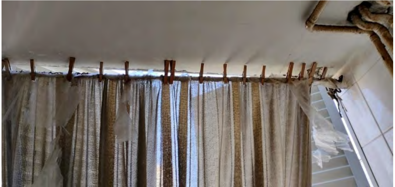
Habitatge 4-1: Oxidació de dintell, cal intervenir
