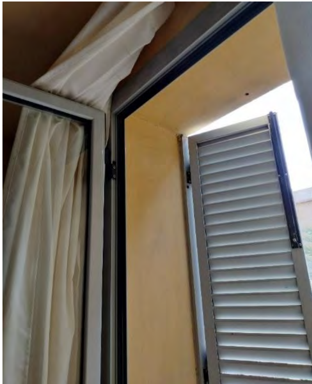
Habitatge 3-1 fissura horitzontal, mol lleugera
