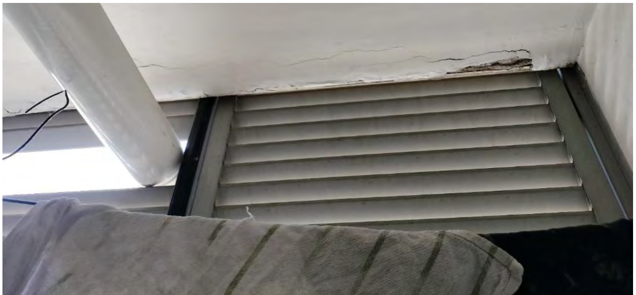
Habitatge 3-4: Oxidació de dintell, cal intervenir
