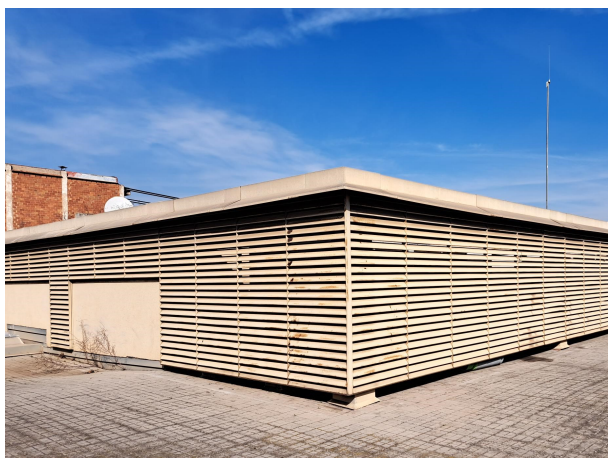
Tancament de les bombes de calor i antena
