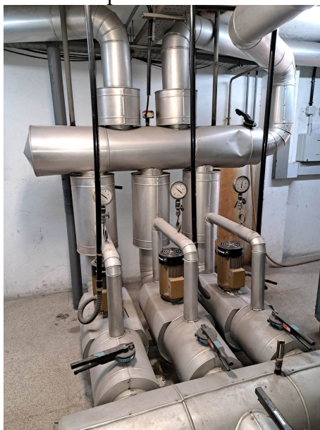
Col·lector impulsió i bombes d'aigua.
