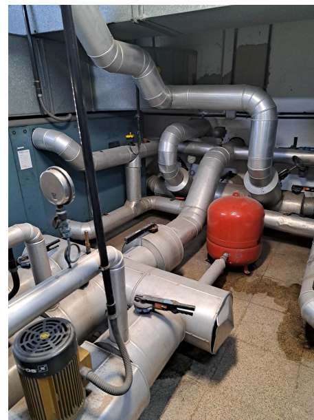
Col·lector aspiració. Dipòsit expansió
