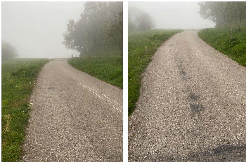
Estat actual del camí fins a El Colomer
