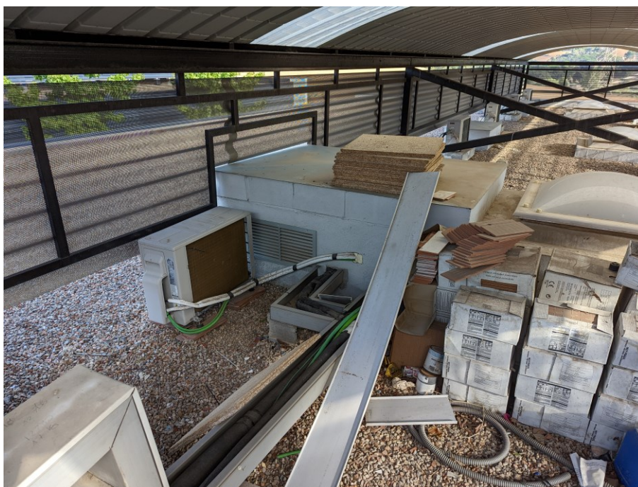
Fotografia 2: Zona instal·lació inversor i quadres de protecció CC i CA
