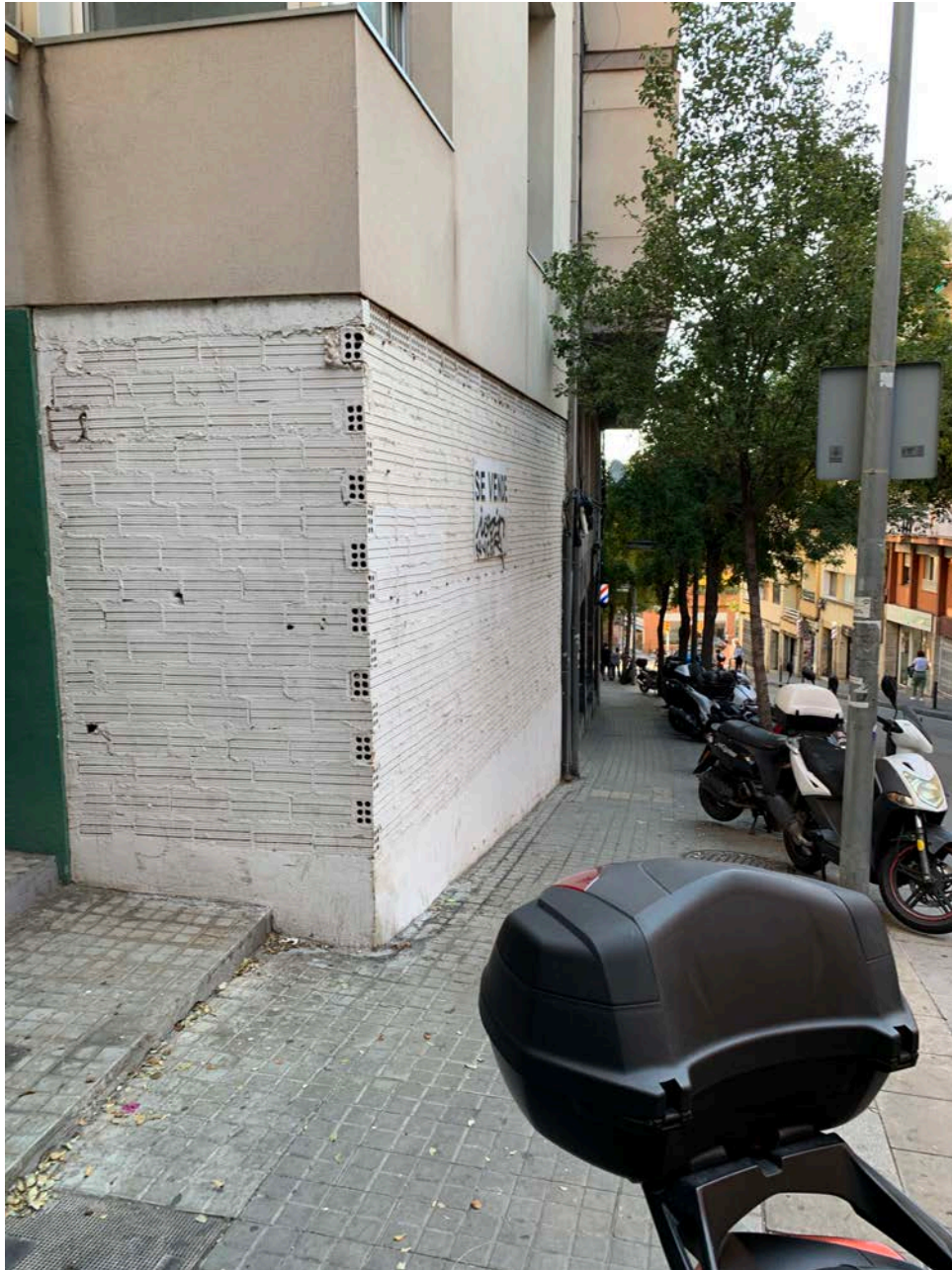
Imatge 03.- Buit en façana tapiat al C/ Dante Alighieri
