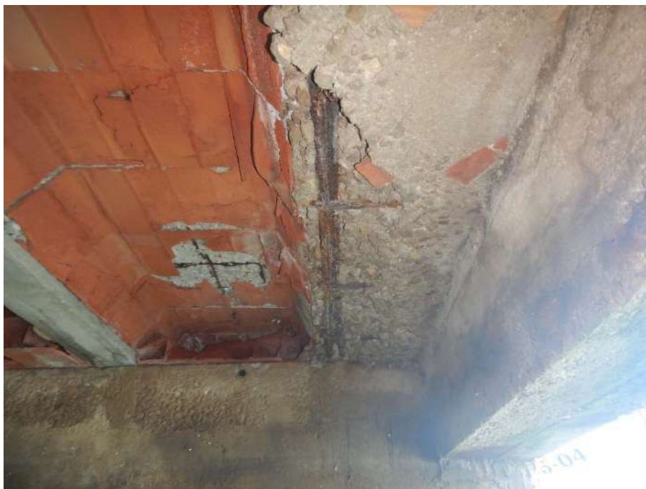
Imatge 3.7. Vista de la part inferior del forjat on s'aprecia la degradació per oxidació de les armadures de la biga cantell, així com l'armadura de la capa de compressió del forjat degut al col·lapse dels cassetons.
