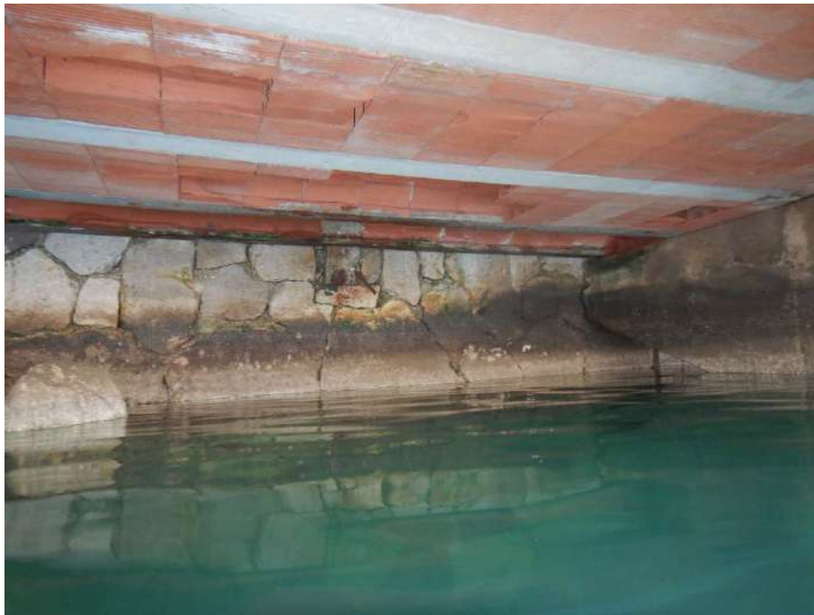
Imatge 3.10. Vista de la part inferior del forjat on s'aprecia la presència d'oxidació a les biguetes del forjat.
