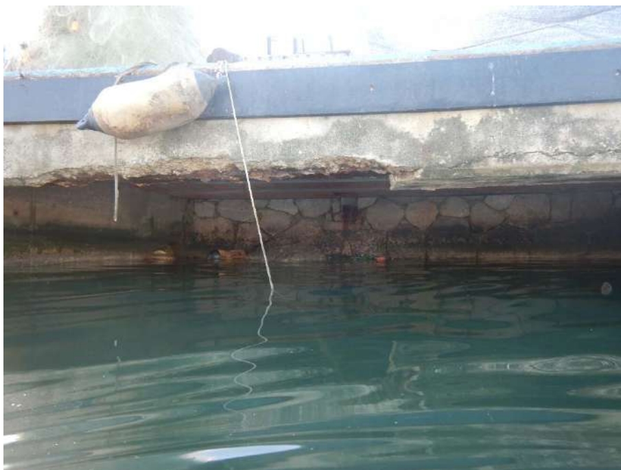
Imatge 3.9. Vista frontal de la biga cantell on s'observa l'avançat estat de degradació de l'estructura amb pèrdua de secció.
