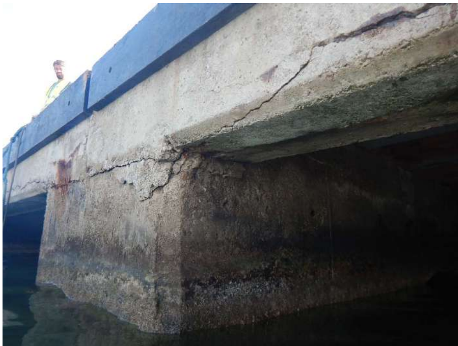
Imatge 3.3. Vista de la zona de recolzaments dels forjats. Es poden apreciar fissures i oxidació en les armadures.
