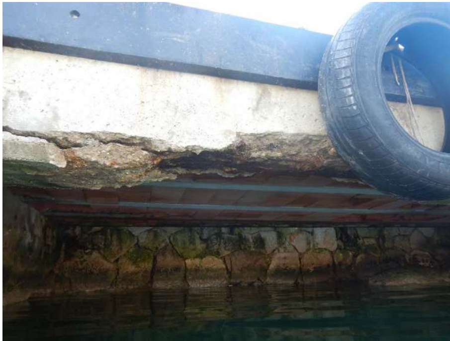
Imatge 3.8. Vista frontal de la biga cantell on s'observa l'avançat estat de degradació de l'estructura amb pèrdua de secció.
