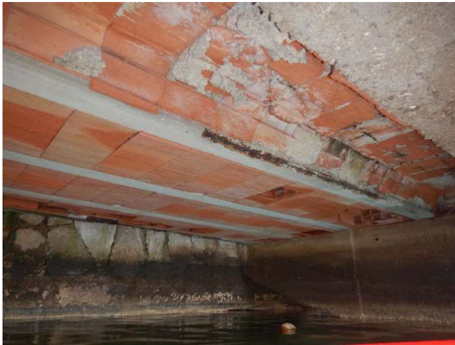
Imatge 3.6. Vista de la part inferior del forjat on s'aprecia la degradació per oxidació de les biguetes.
