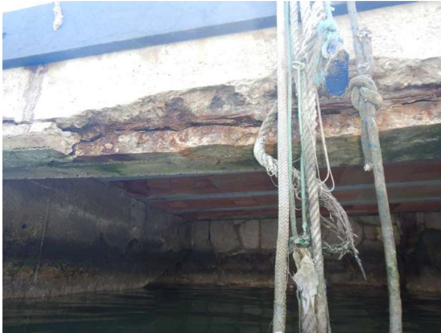
Imatge 3.2. Vista part inferior biga cantell. S'aprecia l'esquerda al formigó i l'oxidació de l'armadura.
