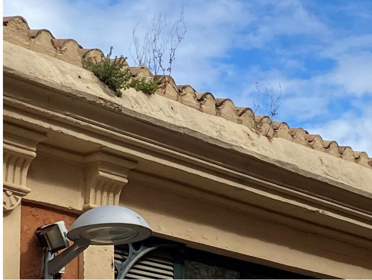
Il·lustració 15.- canal d'obra amb manteniment deficient
