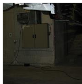
Foto 2. Varios cuadros eléctricos sin señalizar.
