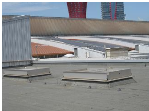
Foto 5. Exutorios no transitables sin señalizar y sin protección.
