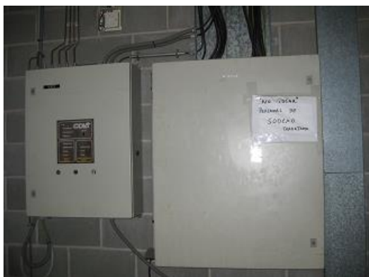
Foto 3. Cuadros eléctricos sin señalización.
