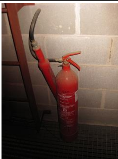
Foto 1. Extintores sin colgar y sin mantenimiento.
