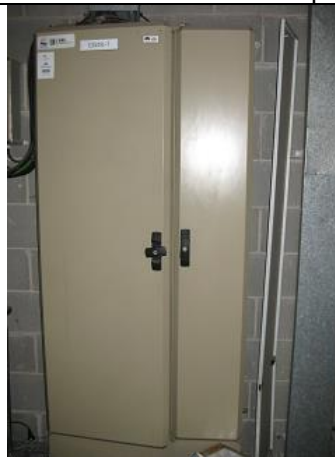
Foto 4. Cuadros eléctricos sin señalización.
