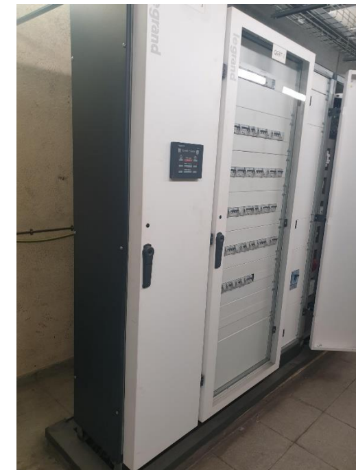
Armari circuits no crítics
