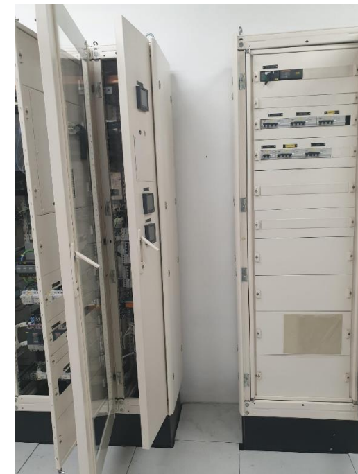
Espai per a nou mòdul interruptors crítics
