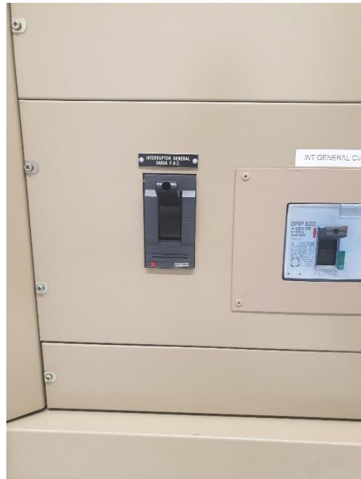
Interruptor 6KV en armari commutació
