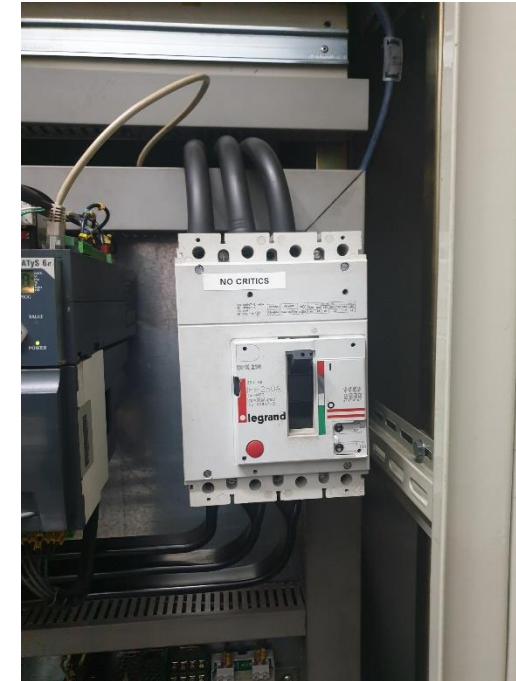
Interruptor general armari circuits no crítics
