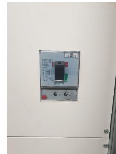
Protecció d'arribada (capçalera) Armari NC QGBT DPX 3 630 de 320A
