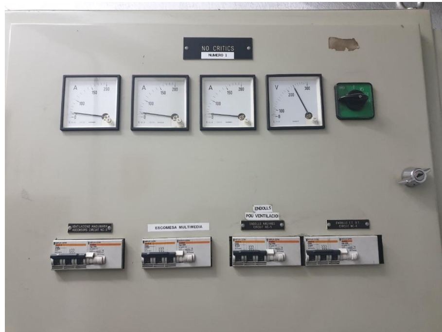
Armari circuits no crítics
