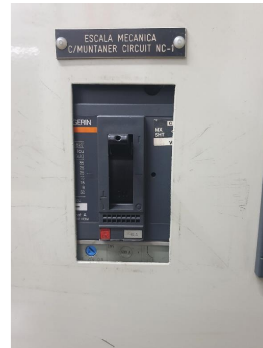
Armari circuits no crítics
