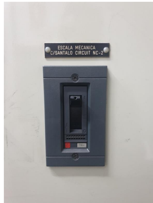
Armari circuits no crítics
