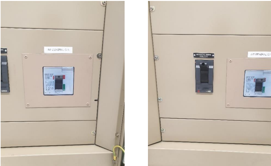
Protecció d'arribada de 6kV (xarxa interna) i de companyia
