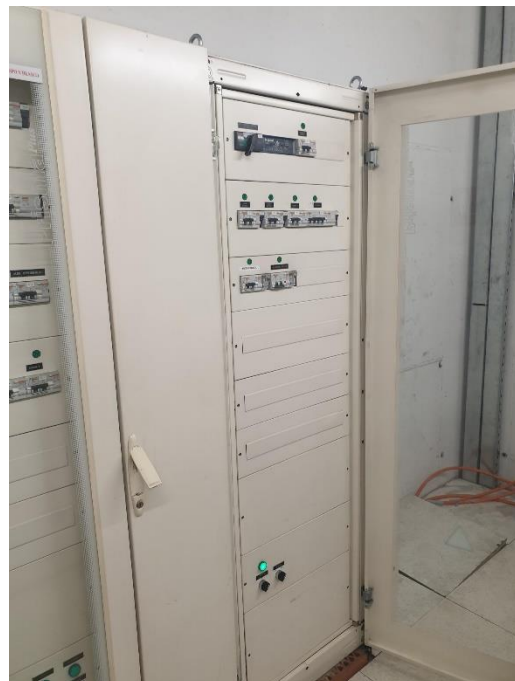
Armari circuits no crítics
