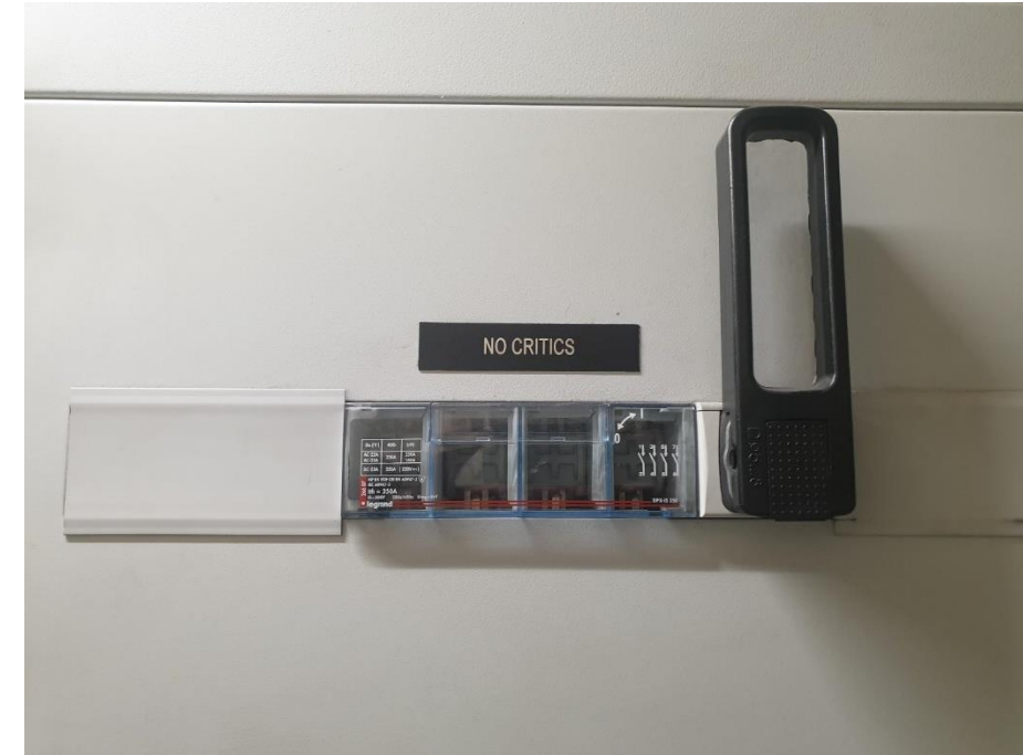
Interruptor seccionador general armari circuits no crítics
