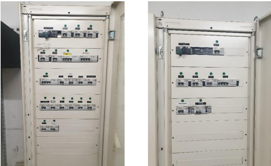
Estat proteccions armari circuits C i NC BT Av. Foix
