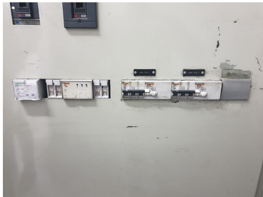
Armari circuits no crítics
