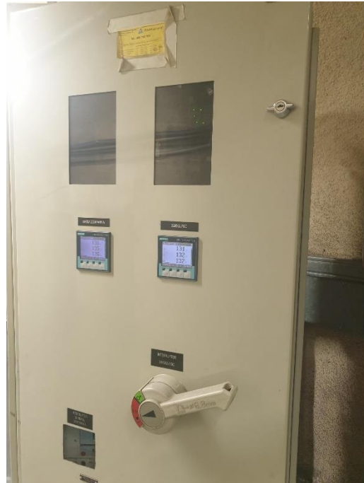
Armari commutació 6kV - CIA
