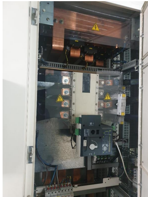
Armari commutació 6kV - CIA
