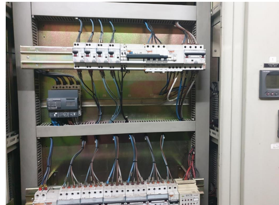
Reserves en armari circuits crítics
