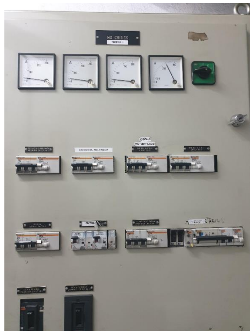
Armari circuits no crítics
