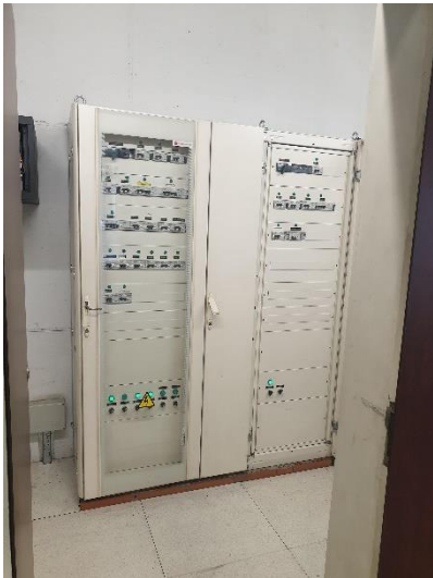
Conjunt d’armari circuits Crítics i No Crítics BT Av. Foix
