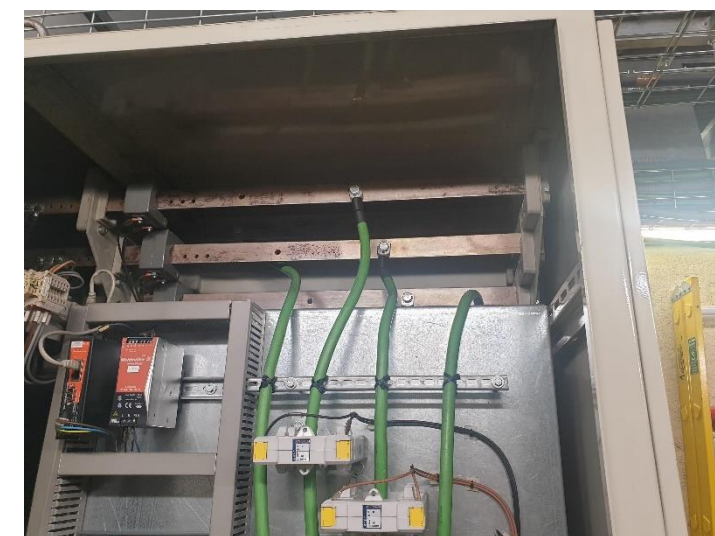
Imatges de l'embarrat de sortida del quadre de commutació
