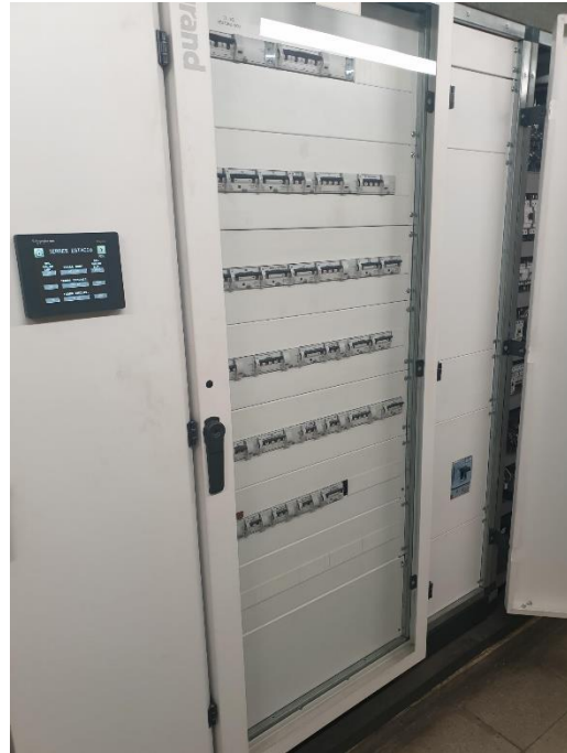
Armari circuits no crítics
