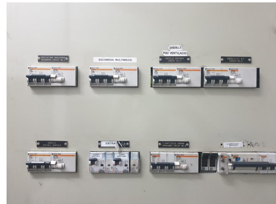
Armari circuits no crítics
