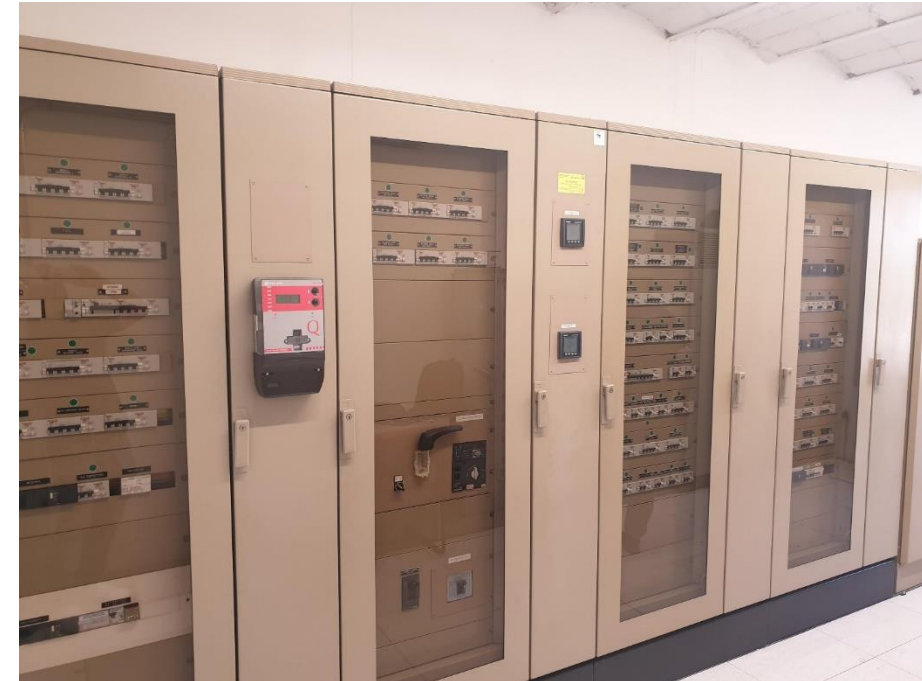
Armaris circuits crítics
