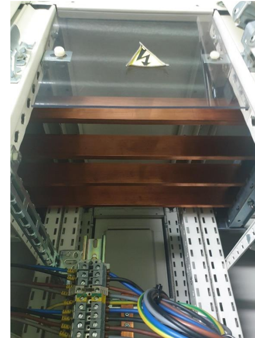
Barres Cu armari crític
