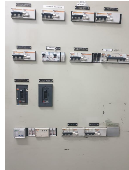
Armari circuits no crítics
