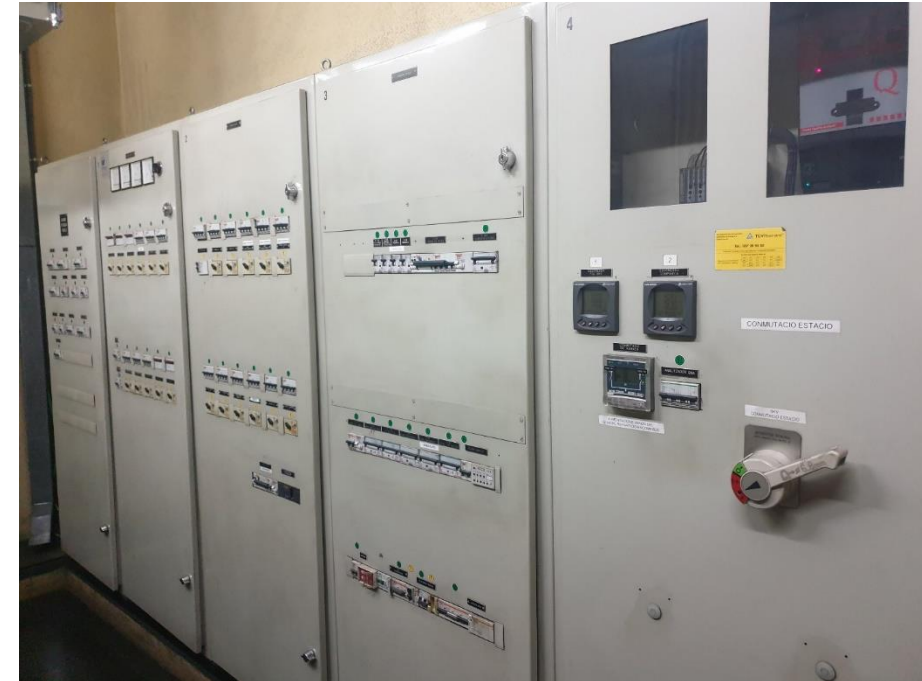
Armari circuits crítics
