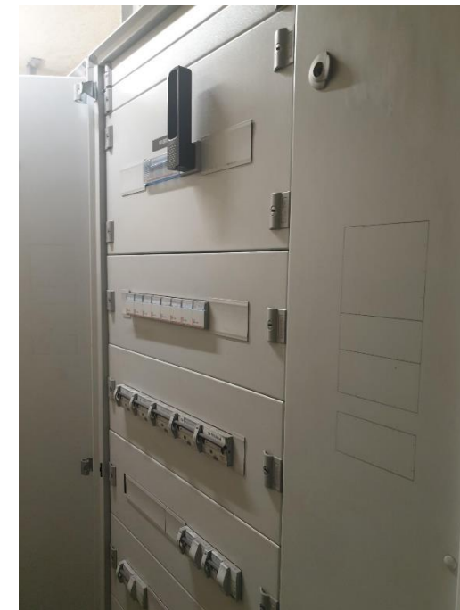
Armari circuits no crítics
