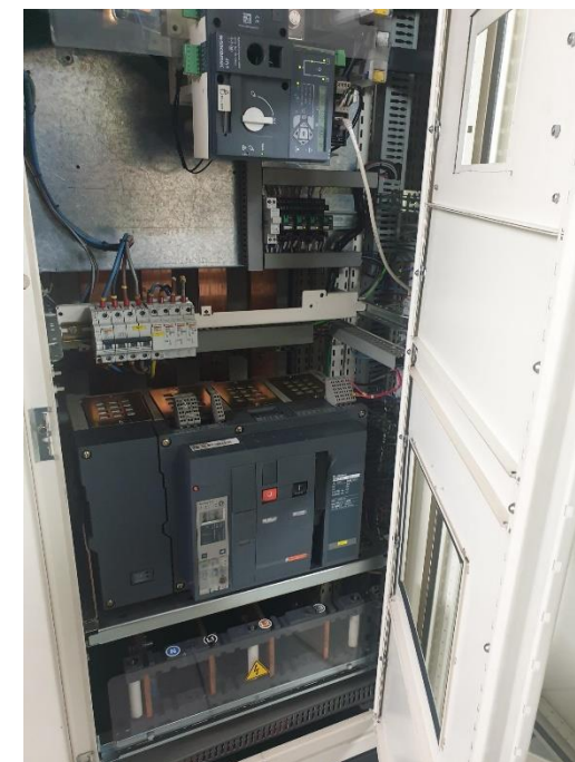
Armari commutació 6kV - CIA
