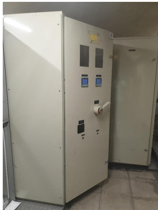
Armari commutació 6kV - CIA
