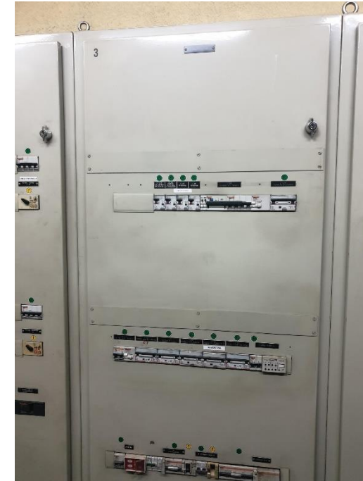
Espai en armari circuits crítics
