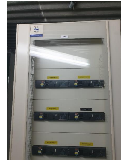
Quadre elèctric amb els circuits actuals NC
