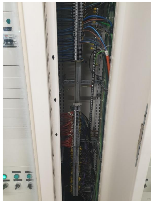
Espai en borners armari circuits crítics
