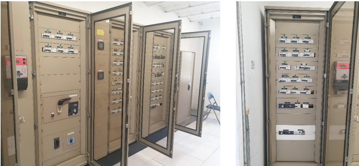
Armari circuits NC i conjunt d'armaris circuits C
