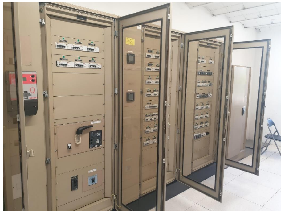
Armaris circuits crítics
