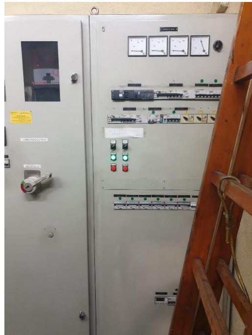
Armari circuits no crítics
