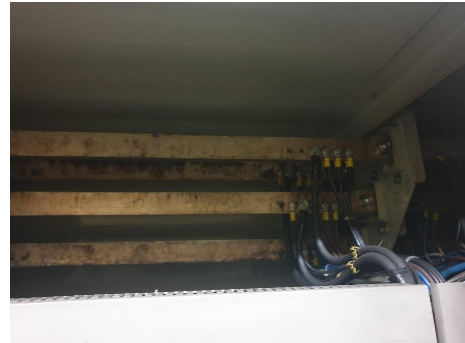
Barres Cu armari circuits crítics
