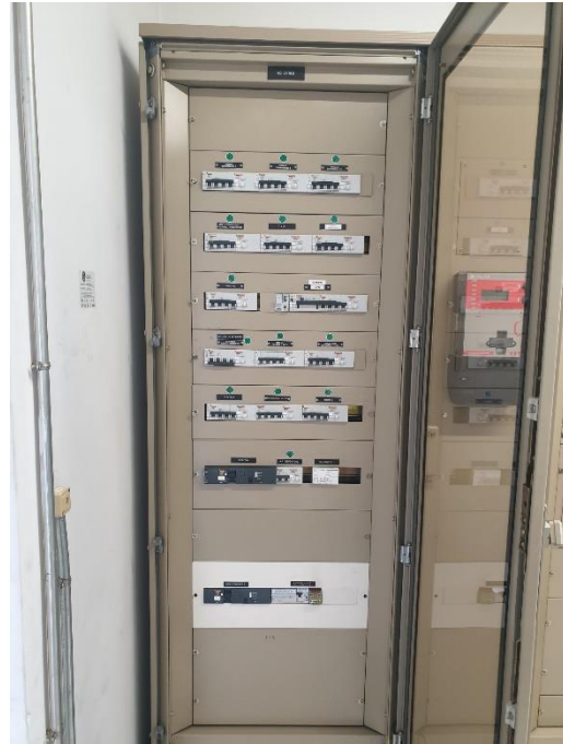
Armari circuits no crítics
