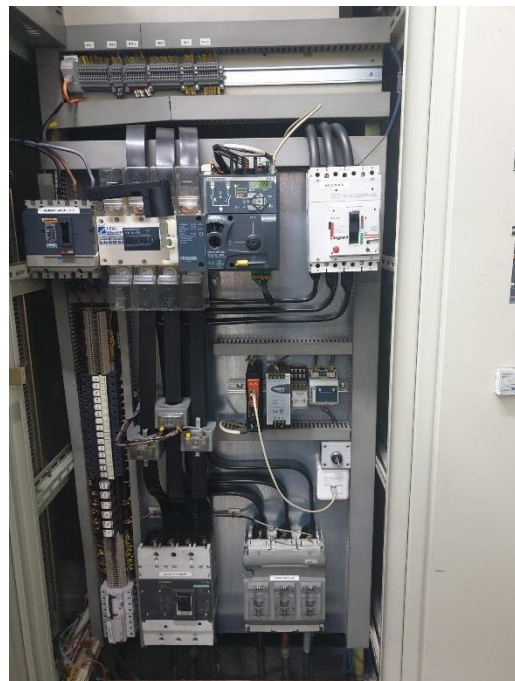
Armari commutació 6kV - CIA
