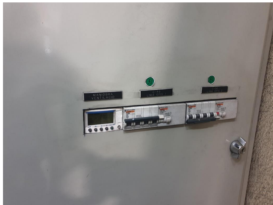
Armari circuits no crítics
