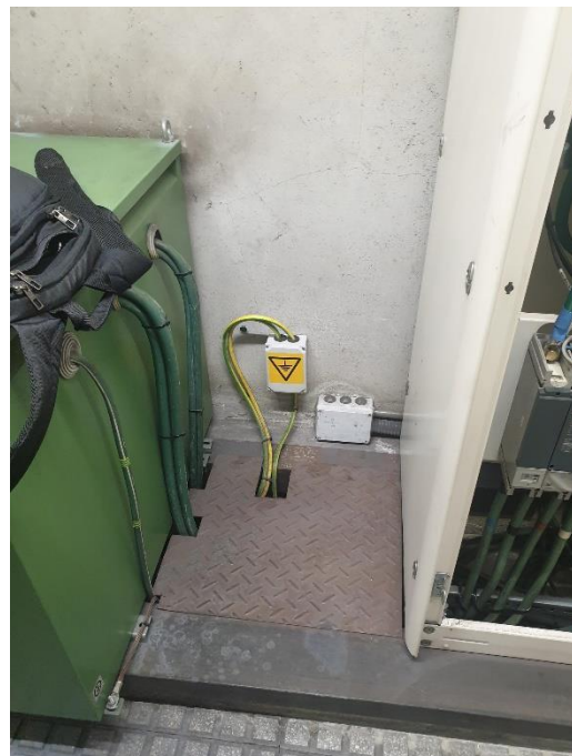
Espai per a nou TRF i PAT existents
