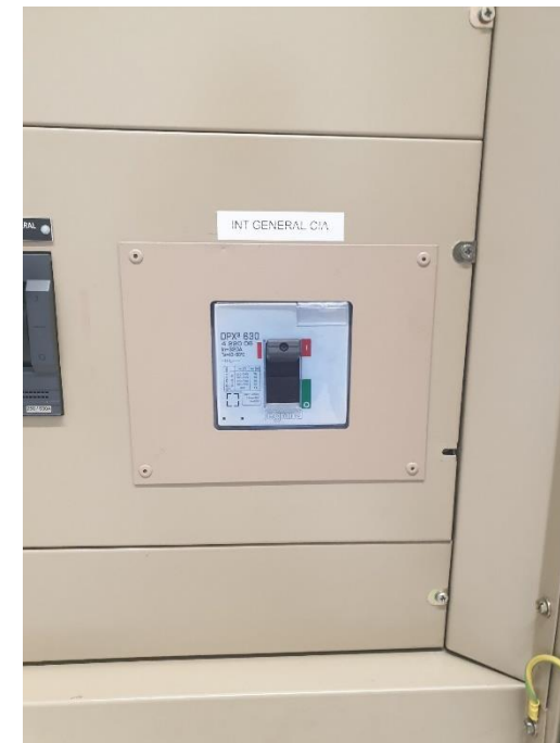
Interrupctor CIA en armari commutació
