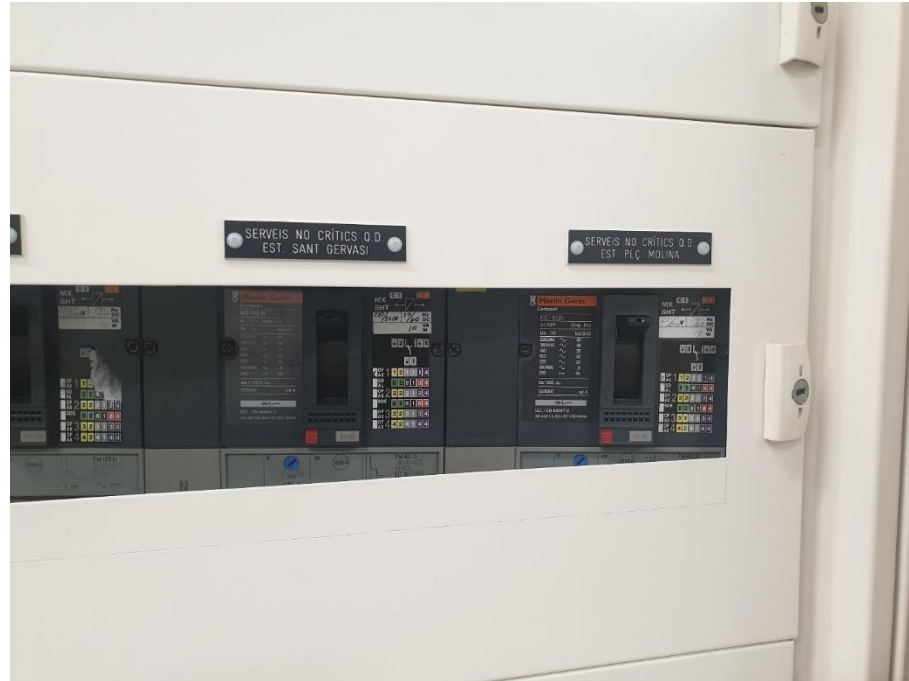
Interruptors generals armaris no crítics
