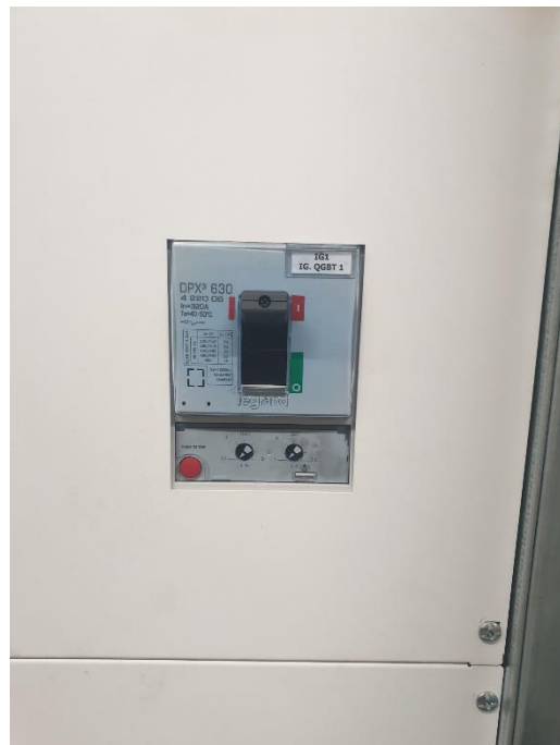
Interruptor general armari circuits no crítics
