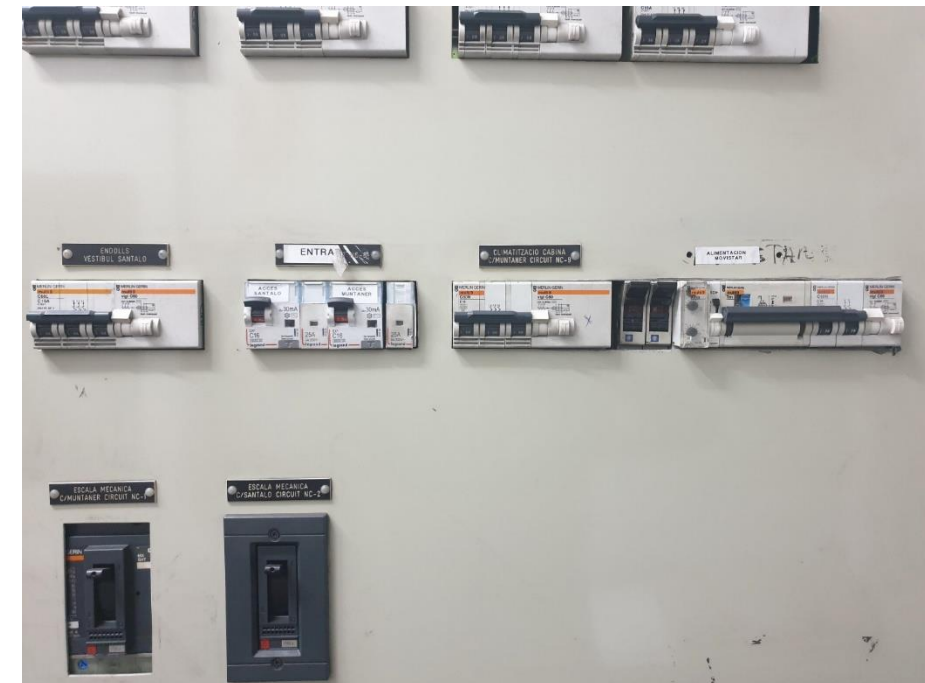
Armari circuits no crítics
