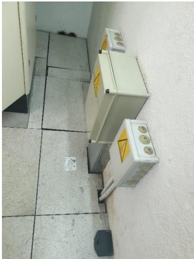
Instal·lació a desconnectar i desplaçar
