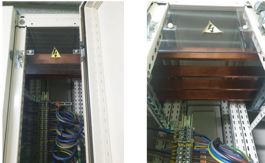
Platines de connexió embarrat crítics actuals
