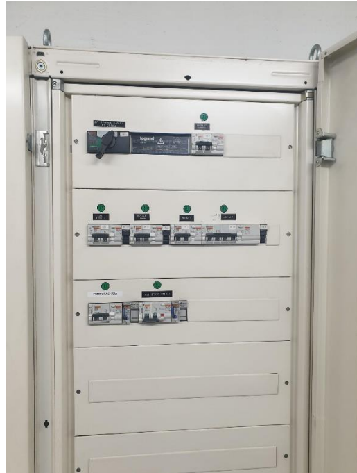
Armari circuits no crítics
