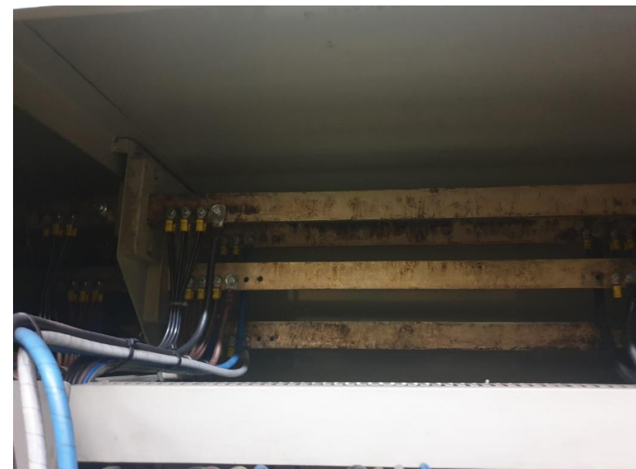
Barres Cu armari circuits crítics
