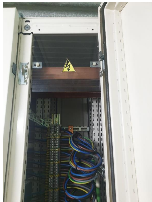
Barres Cu armari crític
