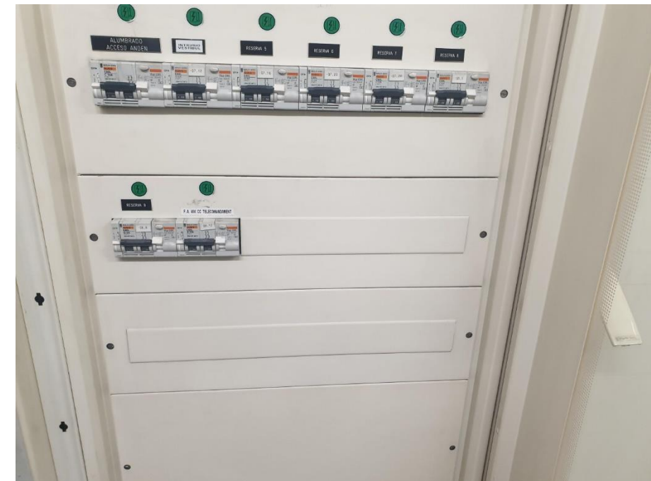
Espai en armari circuits crítics
