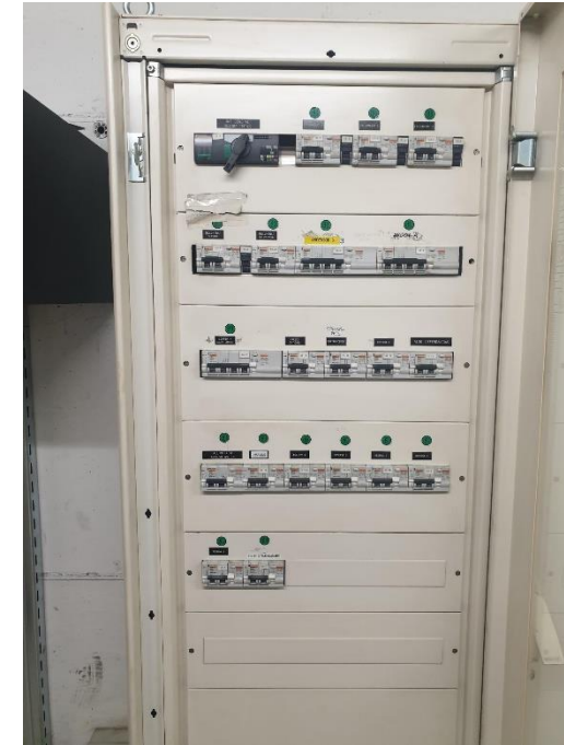
Espai en armari circuits crítics
