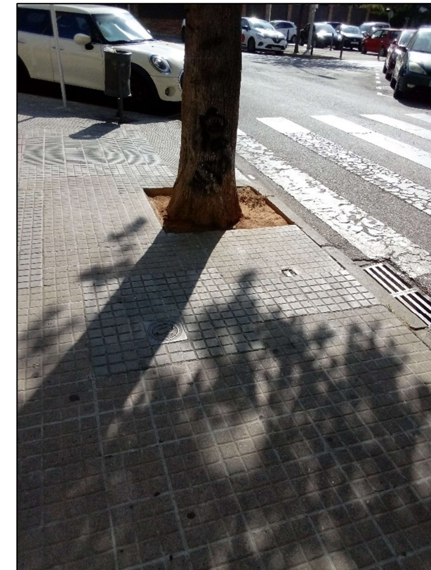
Figura 7. Clau del seccionament i embornal de rebuda del desguàs existent l c/ Pau Casals, cantonada amb el c/ Consell de Cent.
