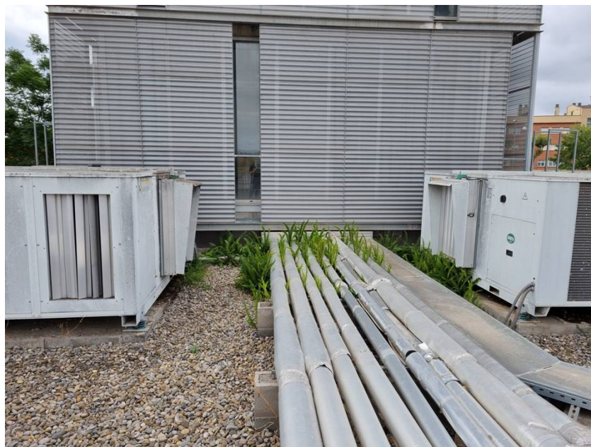
Instal·lacions climatització i conductes
