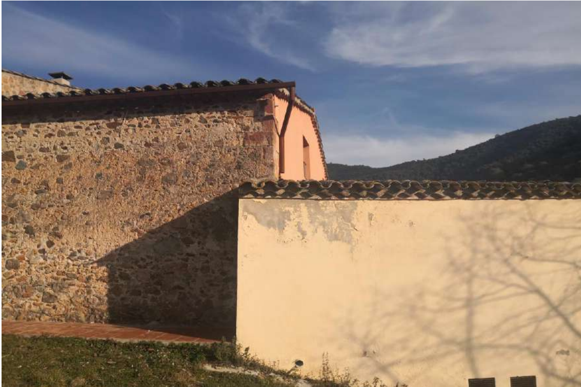
Imatge núm. 2: Canals i baixants existents a la Rectoria de Vallcàrquera. S'observa la canalització superficial existent que es tornaria a habilitar per recollir les escorrenties de la coberta 1c.
