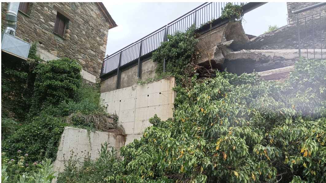
Vistes del mur esfondrat des del camí que baixa pel costat de llevant
