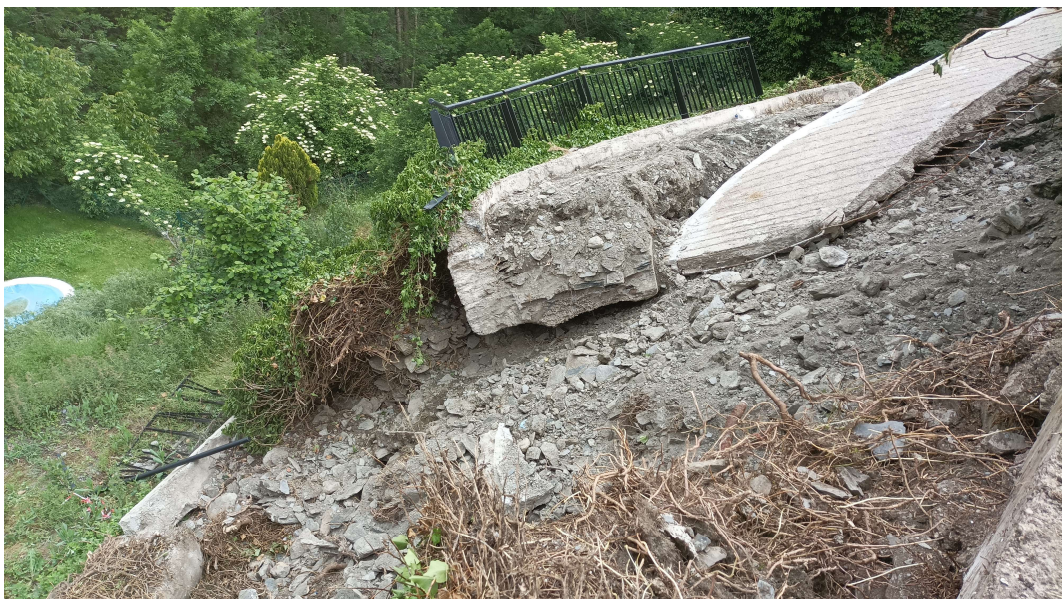
Vistes del mur esfondrat des de la terrassa inferior (on es fonamentava)
