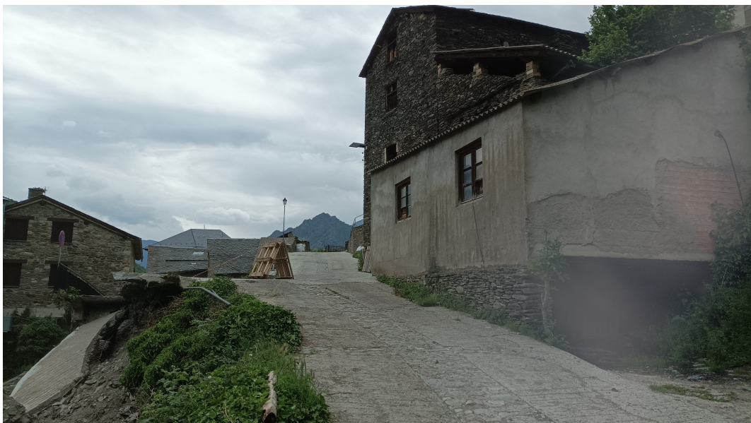
Vistes del vial suportat pel mur esfondrat (vistes sobre el paviment del vial)
