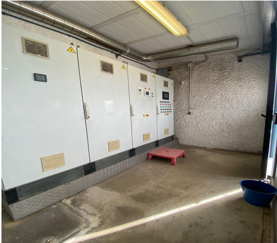
Imatge 5.- Sala de quadres elèctrics centrífuga nova EDAR Teià.
