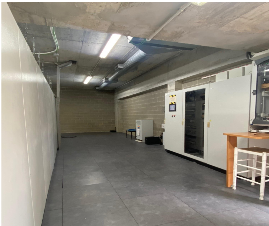
Imatge 8.- Sala quadres elèctrics pretractament EDAR Pineda (Maresme Nord).
