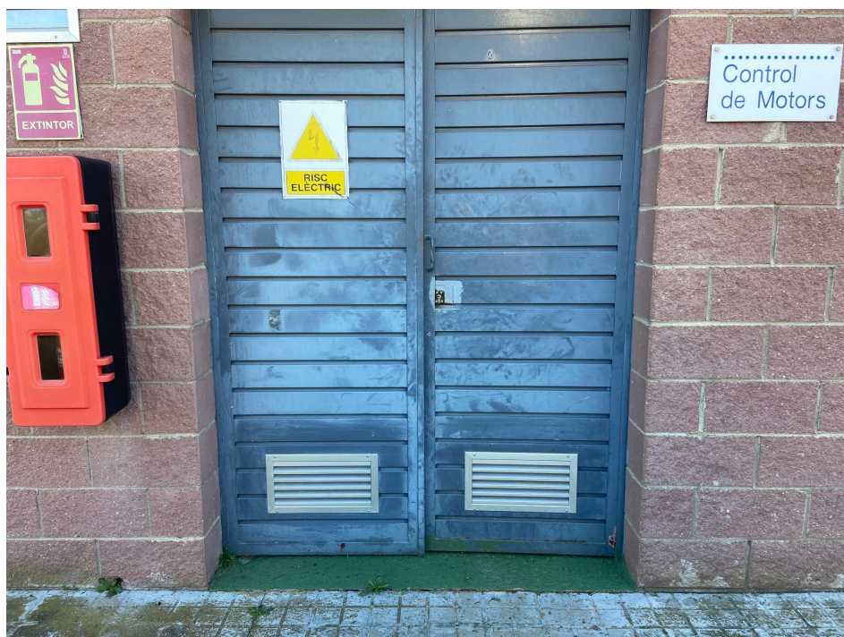
Imatge 4.- Porta d'entrada a la sala de quadres elèctrics bufants EDAR Llanerres.
