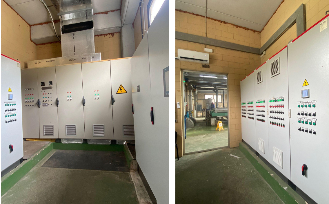
Imatge 1.- Sala de quadres elèctrics centrífugues EDAR Arenys.
