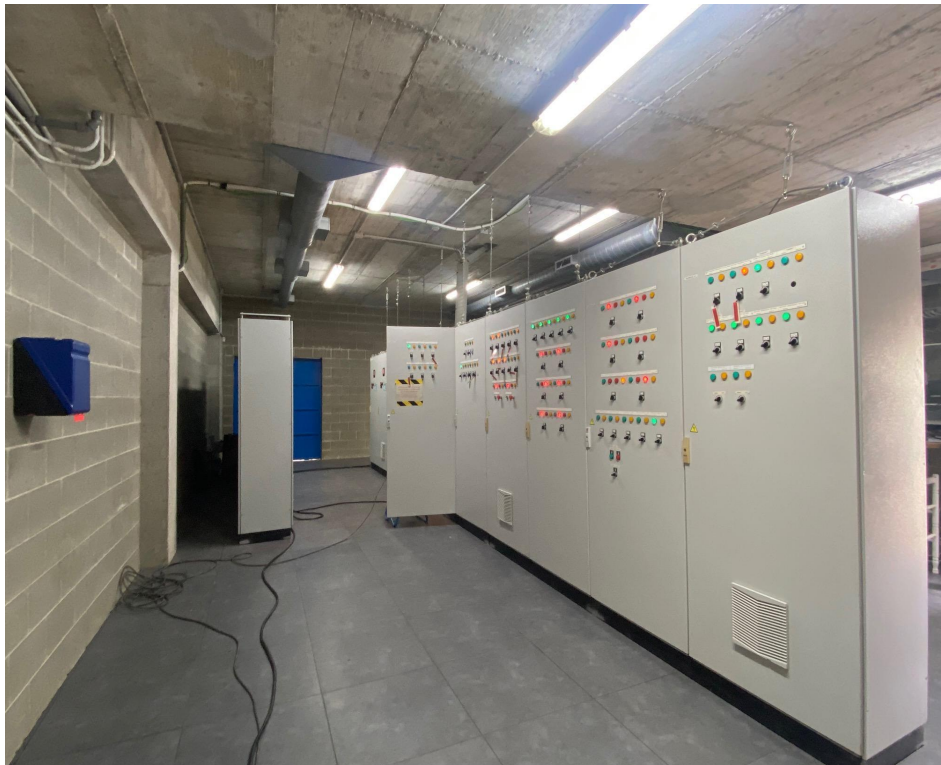
Imatge 7.- Armaris elèctrics de la sala Pretractament EDAR Pineda (Maresme Nord).
