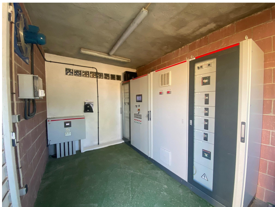
Imatge 3.- Sala de quadres elèctrics bufants EDAR Llanerres.
