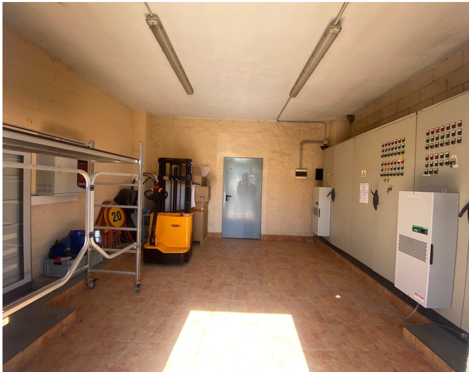
Imatge 9.- Sala quadres elèctrics bufants EDAR Tordera.
