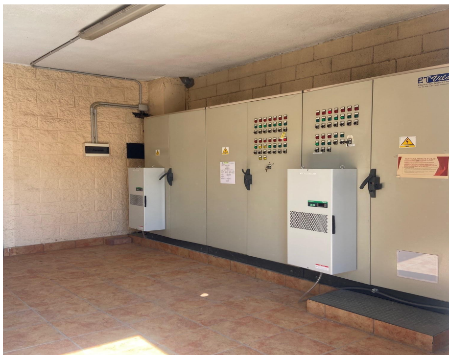
Imatge 10.- Armaris elèctrics de la sala de quadres elèctrics bufants EDAR Tordera.
