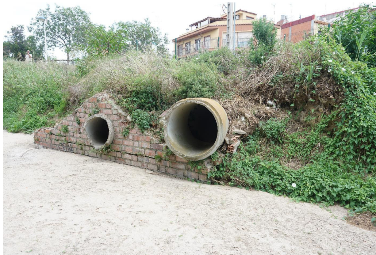
Figura 8. Abocaments de la xarxa d'aigües pluvials (DN600 i DN800).
