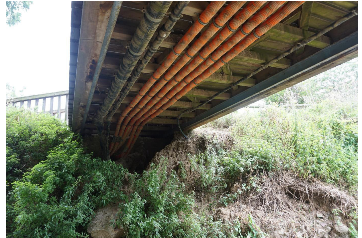
Figura 6. Serveis existents (xarxa de reg amb aigua freàtica i electricitat) passant per la part inferior del pont de fusta.
