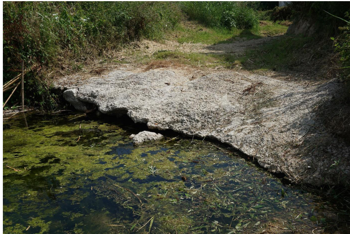
Figura 16. Llosa de formigó erosionada en el seu extrem aigües avall.
