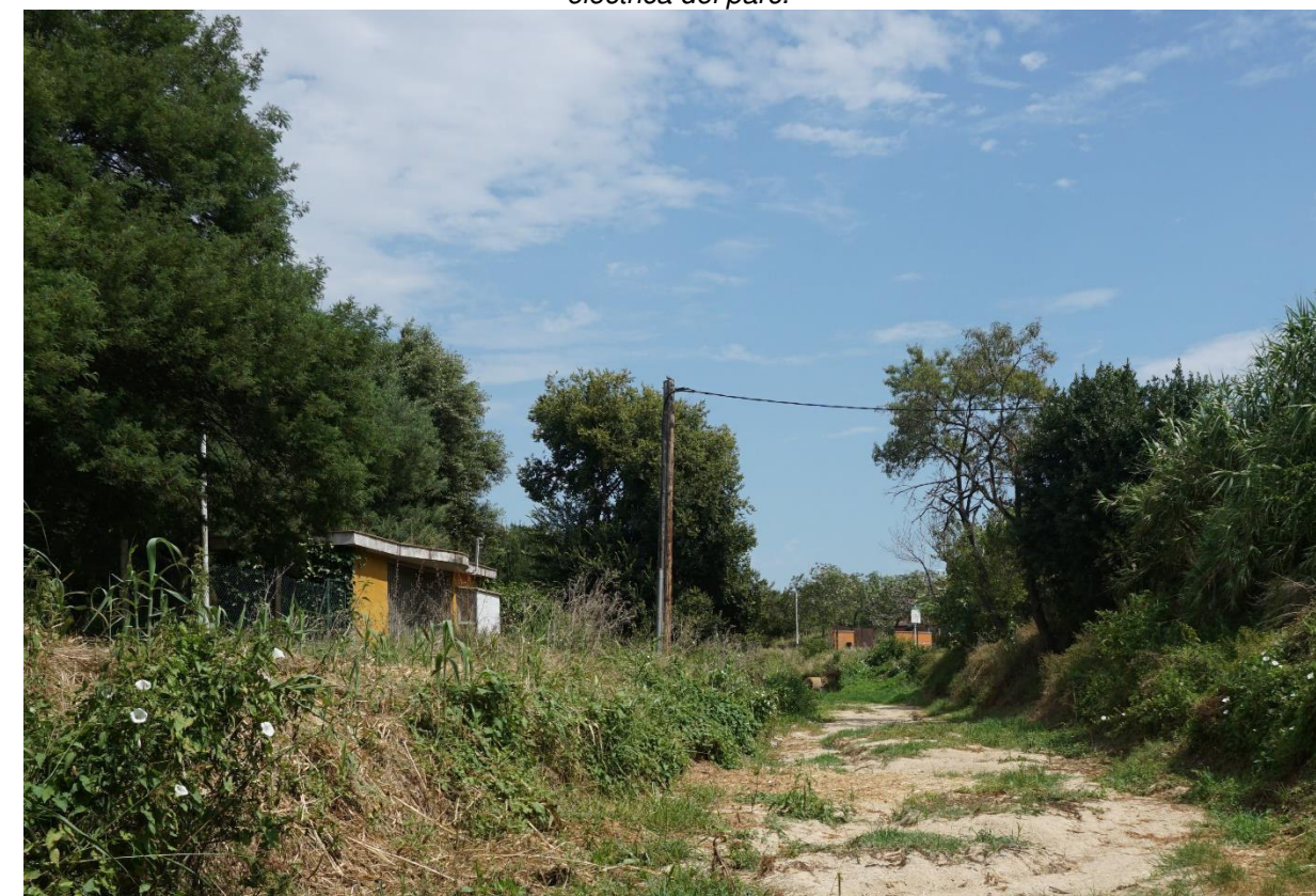
Figura 11. Línia de baixa tensió i caseta amb els quadres de comandament de les bombes de reg del parc i quadre elèctric.
