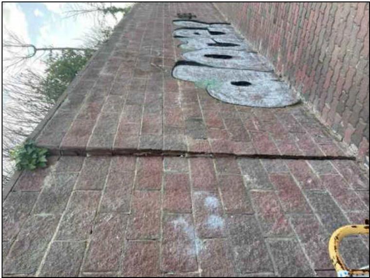
Fotografia 5: Detall lateral mur afectat
