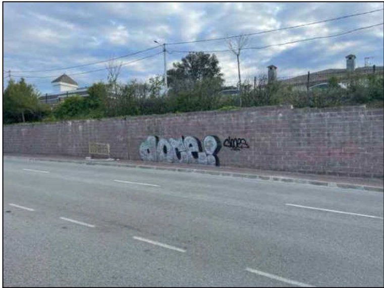
Fotografia 1: Vista general mur afectat
