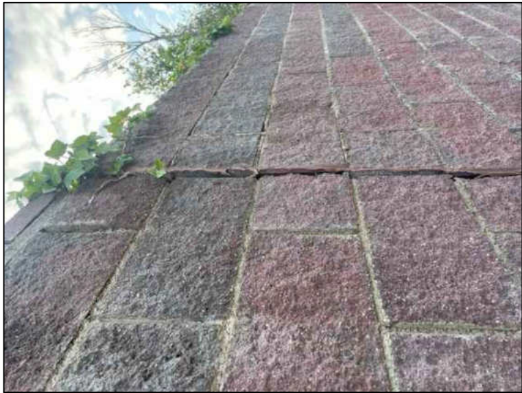
Fotografia 4: Detall lateral mur afectat
