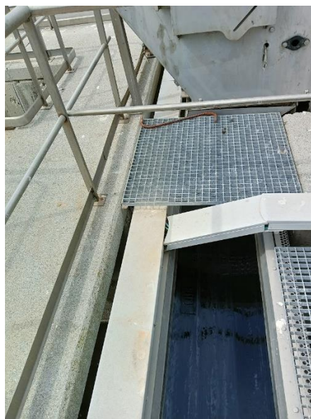
Controlador del sensor de nivell Endress+Hauser Detall safata elèctrica.
