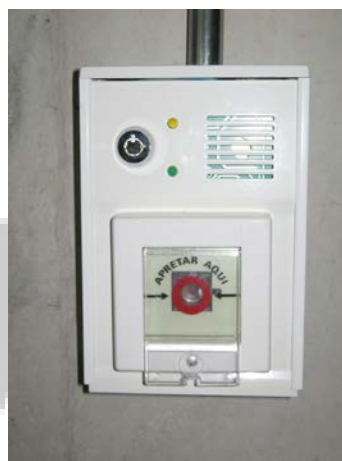
Foto 2: Conjunt pany d'obertura autoritzada, obertura d'emergència, avisador acústic local
