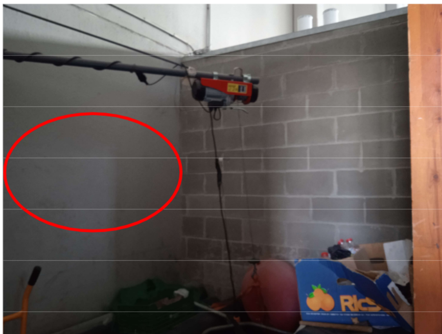
Ubicació prevista per a l'inversor
