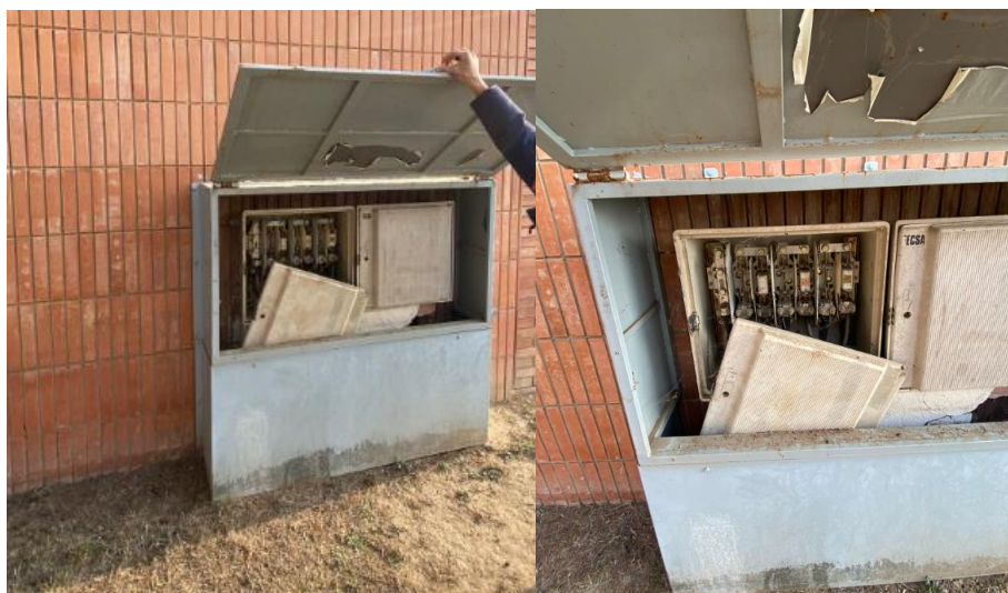
Figura 7. Imagen de la caja de fusibles existente.
