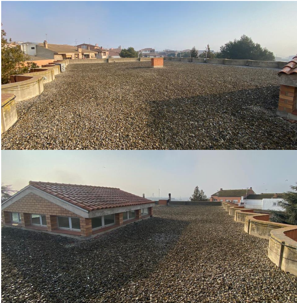
Figura 5. Fotografías del estado de la cubierta.
