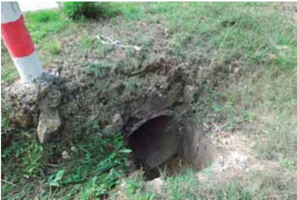
Imatge 04. Obra drenatge afectada PK 1660.00
