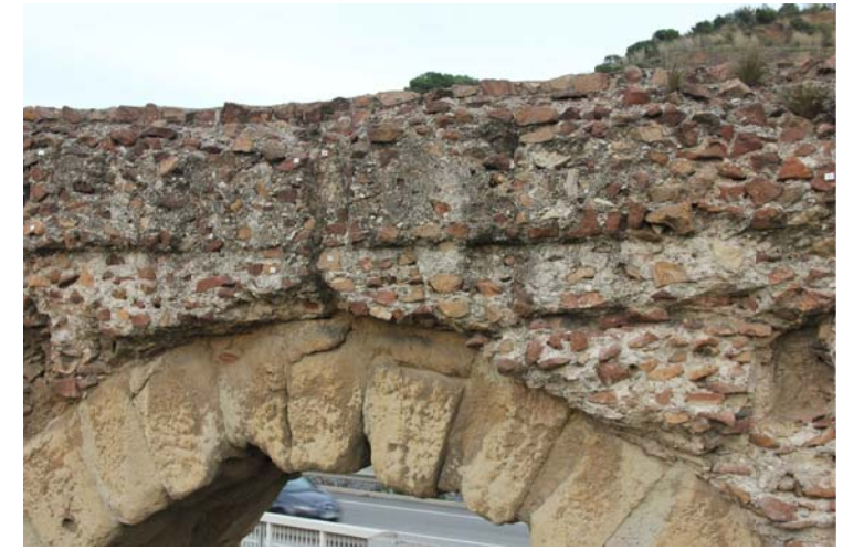
Esquerdes i descamació de les dovelles
