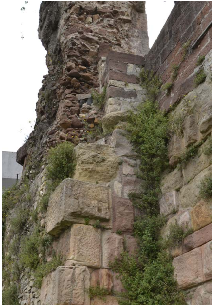
Disgregació del morter/ pèrdua de pedres del rebliment Creixement de vegetació
