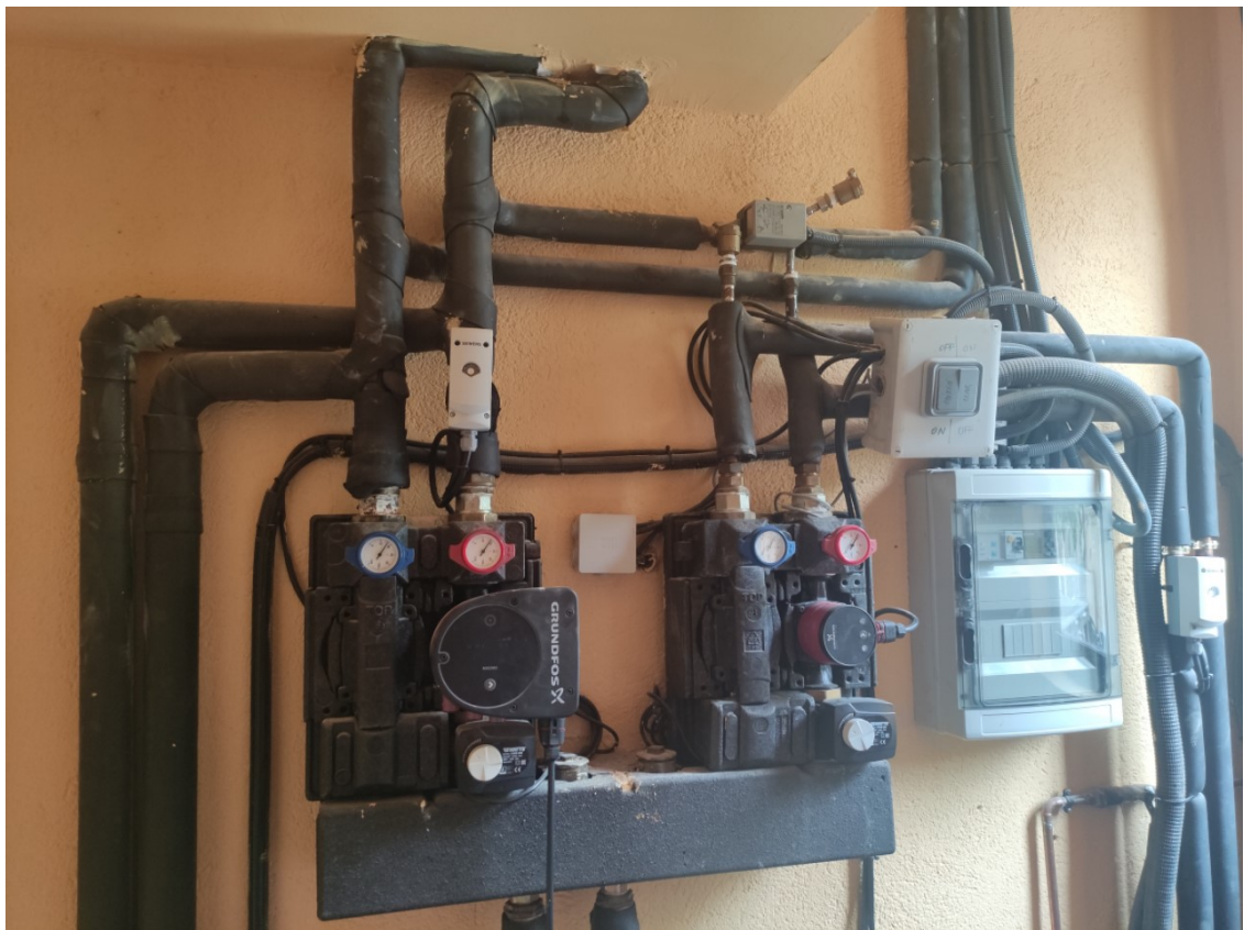
Fotografia 4. Vista estat actual sala caldera PB (circuits impulsió terra radiant)
