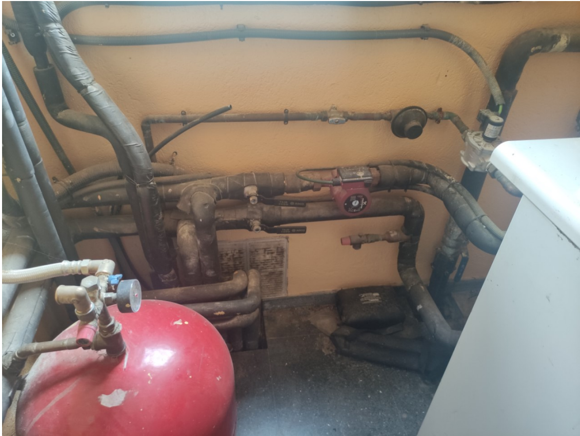
Fotografia 3. Vista estat actual sala caldera PB (caldera i circuits impulsió terra radiant)
