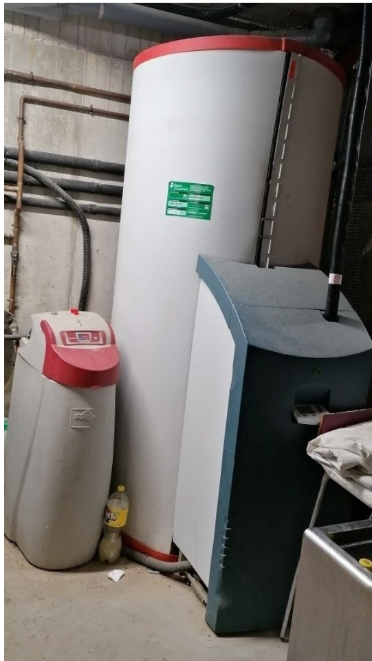
Fotografia 6. Vista estat actual Soterrani (instal·lació solar tèrmica )
