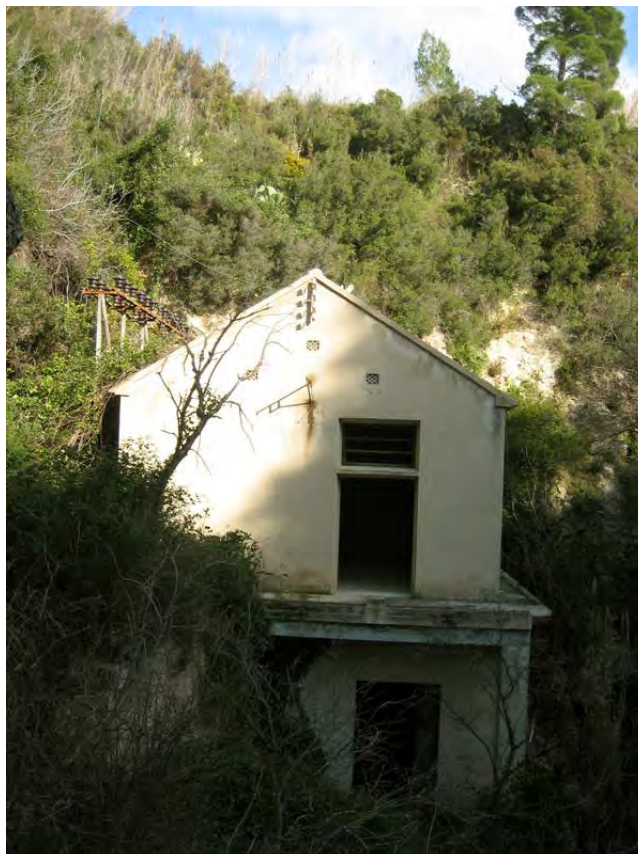
Hidroelèctrica de Malany
