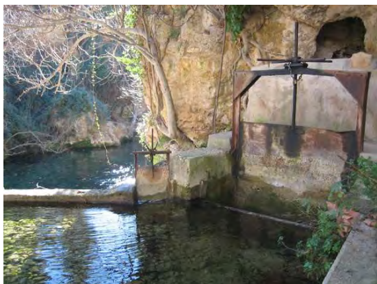
Imatge 19. Captació CR Ulldecona
