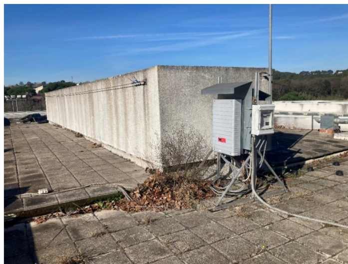
Foto 5. Vista sud cos sobresortint amb detall pas sud entre cobertes i detall estructura i equips instal·lació fotovoltaica i línia de vida a paret
