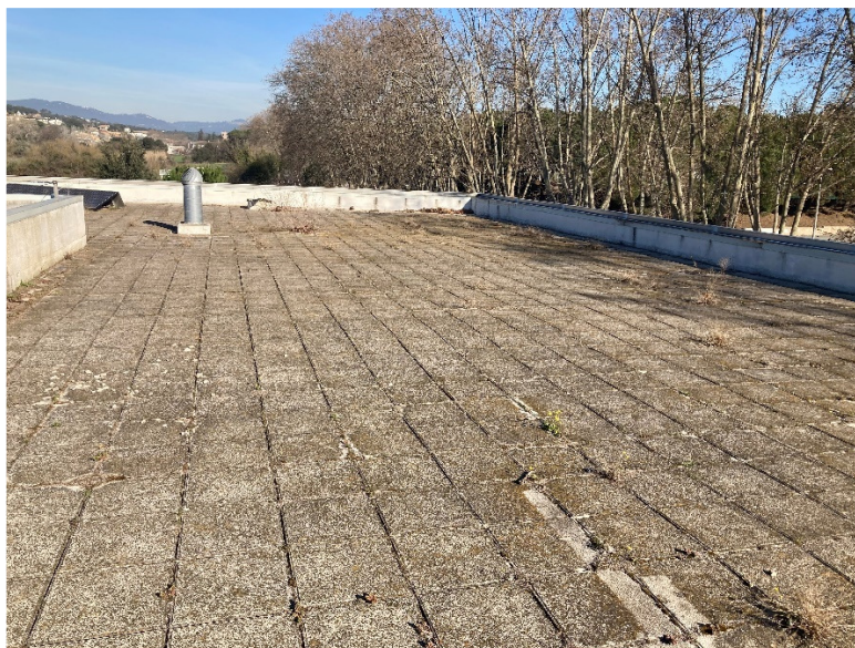
Foto 1. Vista vessant nord coberta 1 amb instal·lació mitjançant suports 15º amb llast
