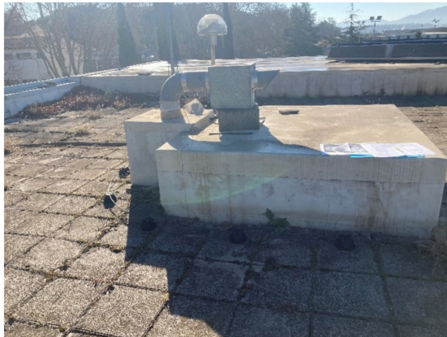
Foto 7. Cos sobresortint ascensor. Punt accés interior a través lateral caixa ventilació
