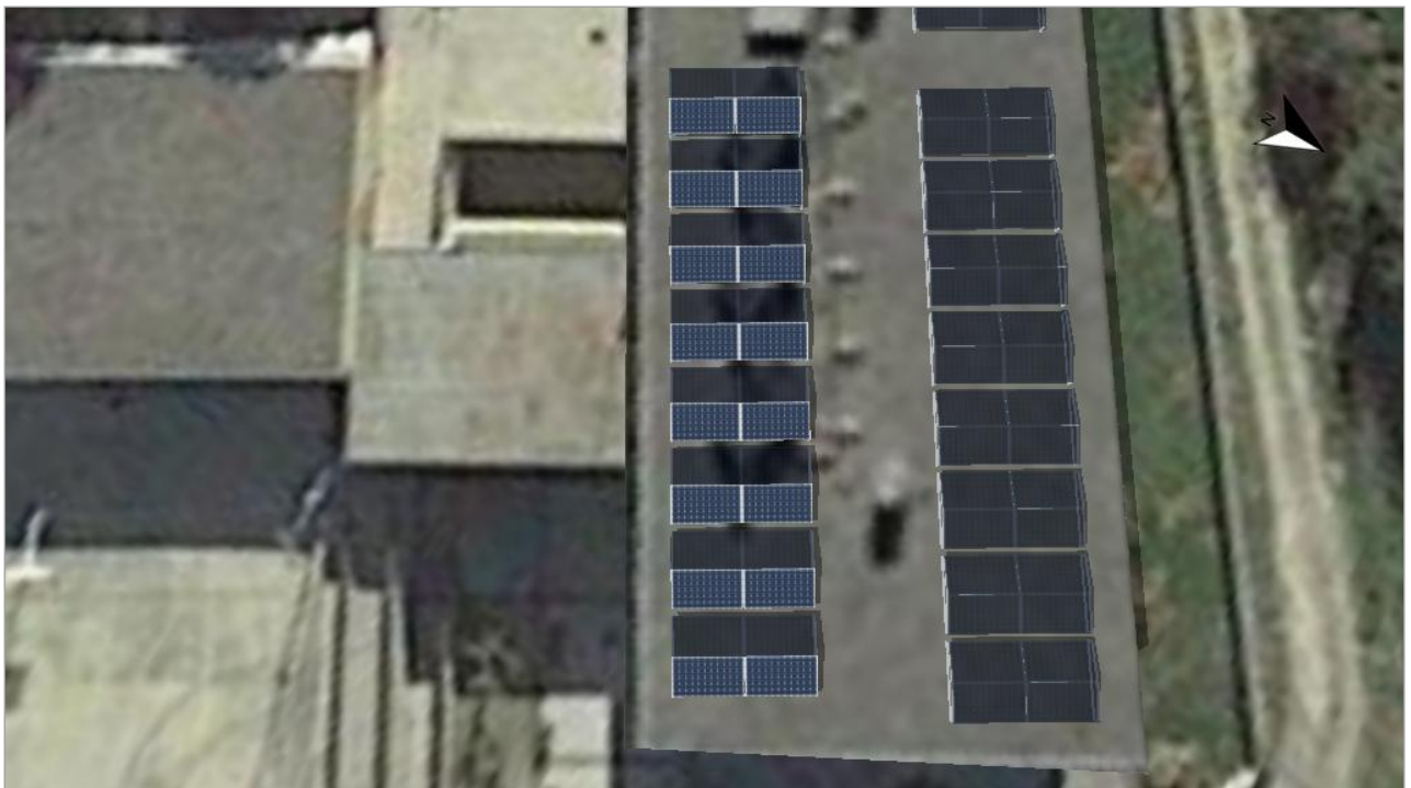
Figura: 7. Superficie fotovoltaica - 4
