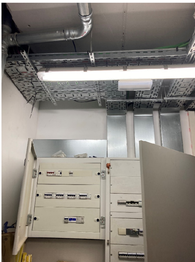
Foto 4. Vista canalitzacions en sala quadre general
