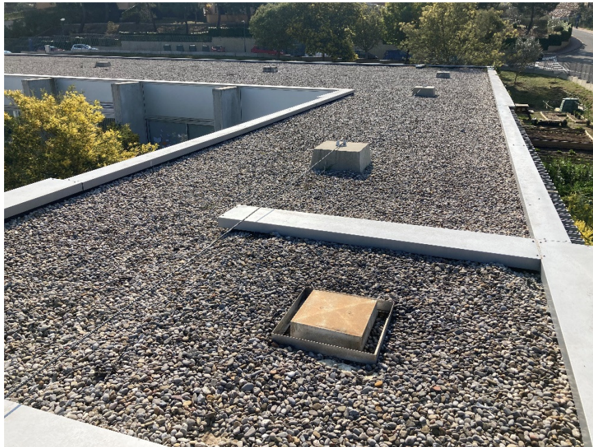
Foto 2. Tram de coberta ubicació estructura suportatge equips fotovoltaics i de punt accés interior edifici a través de muntant vertical
